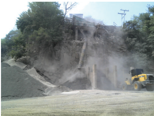
Figura 5.10 – Planta de britagem de basalto em operação com grande emissão de poeira. O impacto ambiental decorrente é a redução da qualidade do ar. Notar também a película de poeira que se deposita sobre a vegetação. Ponto OS-050.
