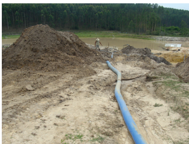
Figura 5.8 – Depósito de estéril (solo orgânico) em mineração de areia, onde não há nenhum controle ambiental no armazenamento. O transporte de sedimentos pelas águas pluviais pode causar o aumento do assoreamento e da turbidez do curso d'água existente. Ponto GP-010.
