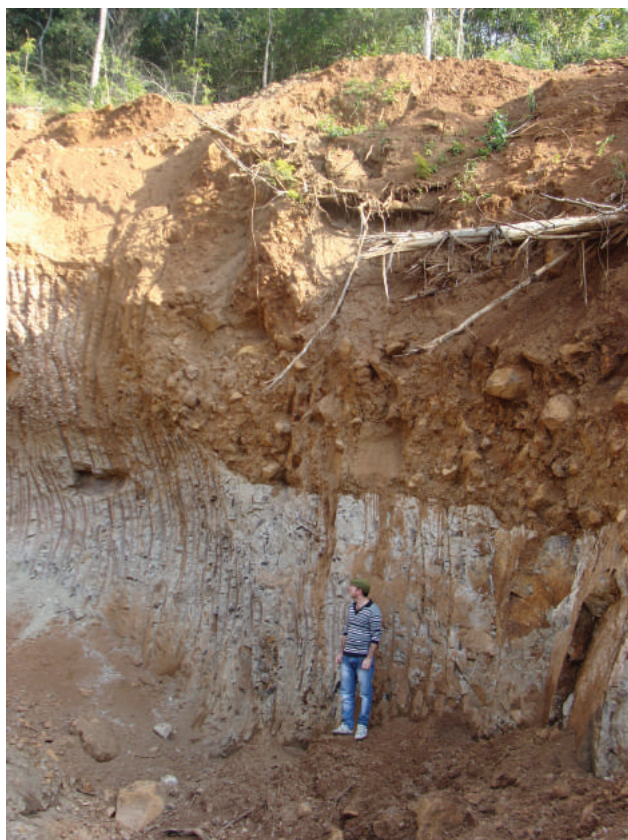
Figura 5.4 – Talude de corte vertical em mineração de saibro expondo contato entre saprólito de basalto (inferior, cor cinza) e colúvio (superior, cor marrom). A configuração do corte resulta na desestabilização geotécnica do substrato, promovendo alto risco da ocorrência de deslizamentos e queda de blocos. Ponto GP-122.
