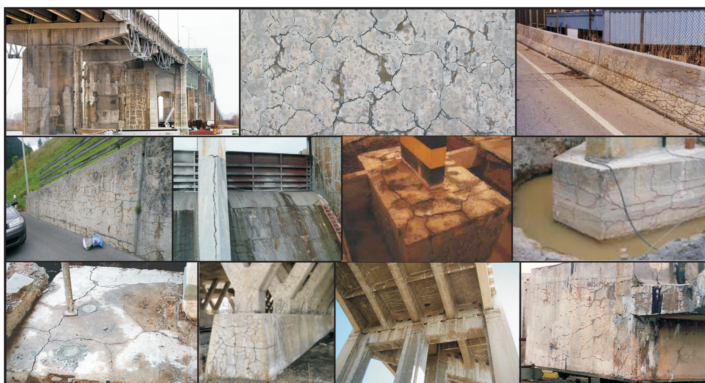
Fotografias mostrando o resultado da Reação Álcali-Agregado em estruturas de concreto.
