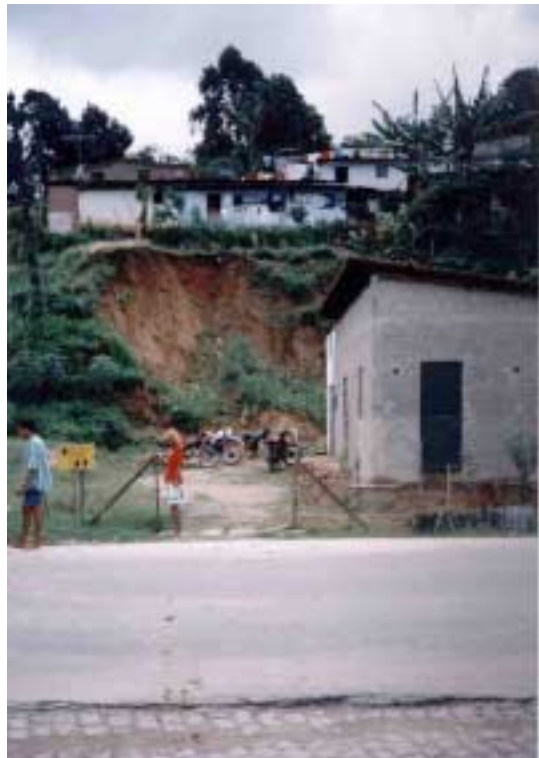
Deslizamento (Estrada da Luz)
