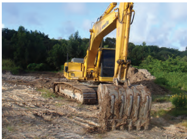
Foto 12 – Extração mecanizada de argila, de coloração amarela e cinza, da planície de inundação do Rio Pirapama. Área de exploração da Mineração Itapoama. Depósito do Engenho Caramuru, Cabo de Santo Agostinho.
