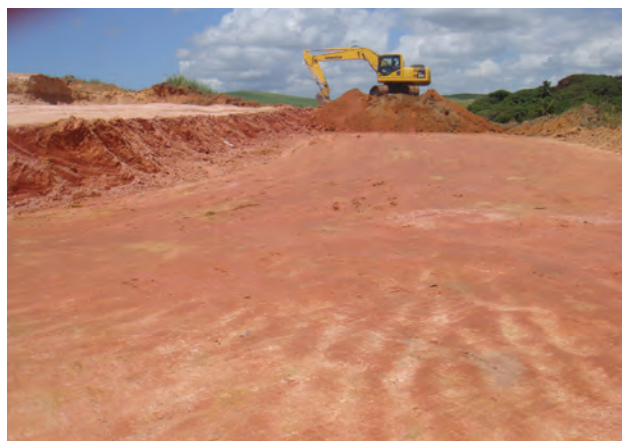
Foto 30 - Desmatamento e remoção de solo na Estrada Maracaípe-Serrambi, em Ipojuca.
