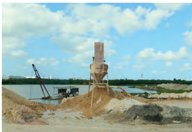
Foto 1 – Tentativa pioneira para recuperação de areia (areia lavada) em cava submersa através do beneficiamento de arenitos argilosos do Grupo Barreiras. Depósito de Guararapes, Jaboatão dos Guararapes.
