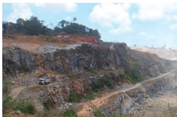
Foto 24 – Extração de material de empréstimo do capeamento siltico-argiloso, avermelhado, resultante da intemperização in situ de granitoide. Pedreira Líder, Engenho Recreio/Jaboatão dos Guararapes.
