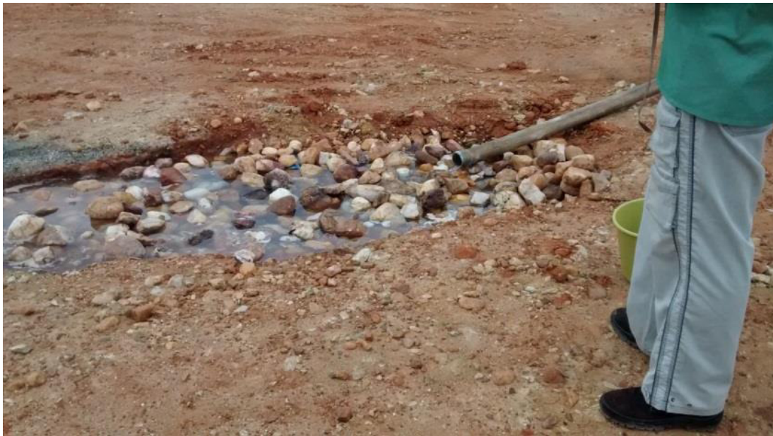
Figura 4.11 - Água sendo injetada pelo caminhão pipa diretamente na trincheira no Sistema Piloto da Escola Municipal. A camada de xisto presente próximo à superfície se comportou como uma barreira hidráulica não permitindo que a água infiltrasse e chegasse à fratura monitorada pelo poço.
