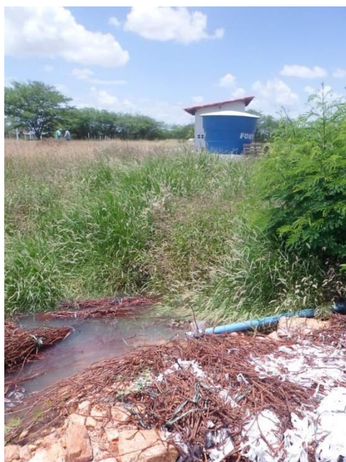
Figura 4.12 - Trincheira de recarga mal preenchida e localizada mais distante do poço de monitoramento no Sistema Piloto da RKF mudas.
