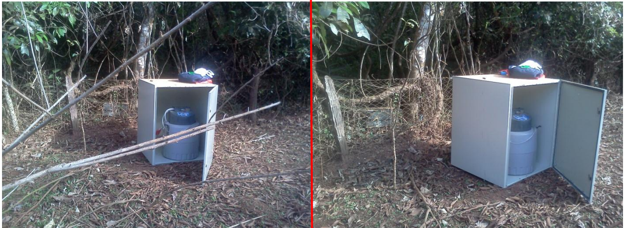
Figura 17 - Amostrador / coletor de amostras instalado no ponto de medição (Fonte: o autor).
