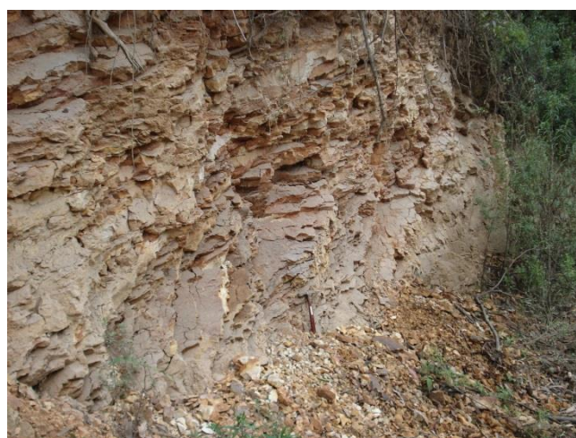
Figura 3.60: Observam-se as camadas inclinadas do escorregamento.
