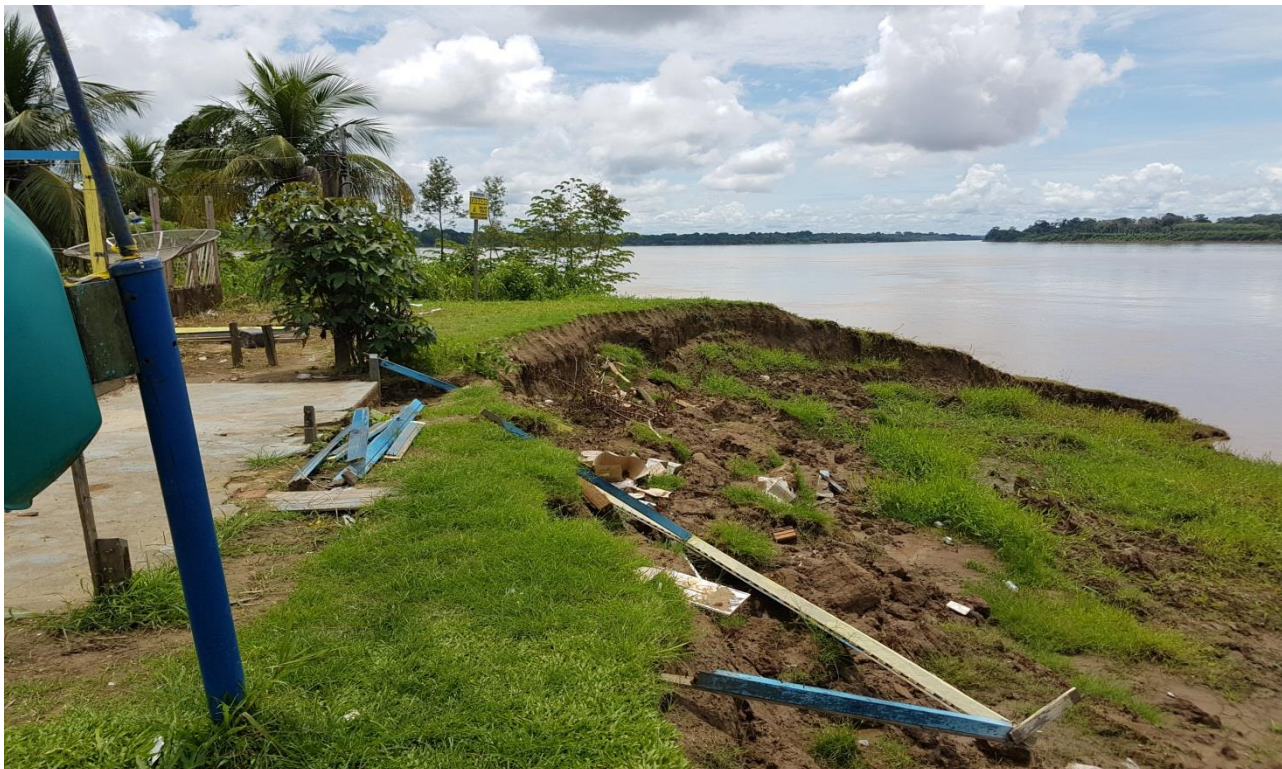
Figura 2 – Erosão fluvial, rio Madeira, extremo de jusante, Distrito de Nazaré. Distância da crista da erosão para as residências menor que 2 metros. Observa-se que uma ocupação foi atingida no local. Nota-se também, descarte inadequado de lixo doméstico.
