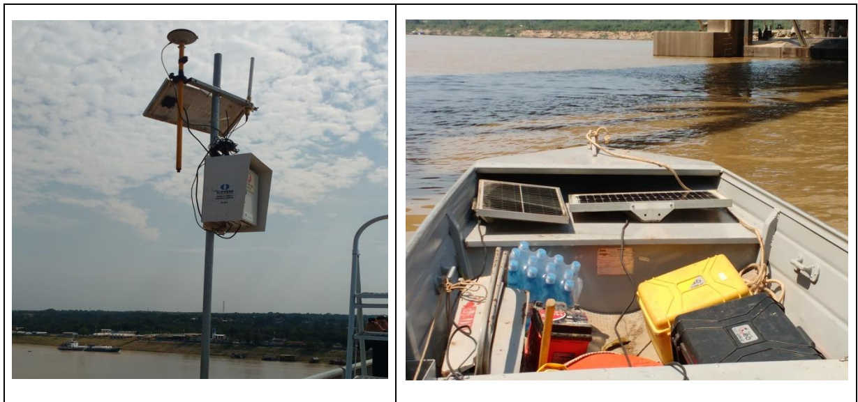
Figura 4 - Montagem dos equipamentos com alimentação da energia por painéis solares.
