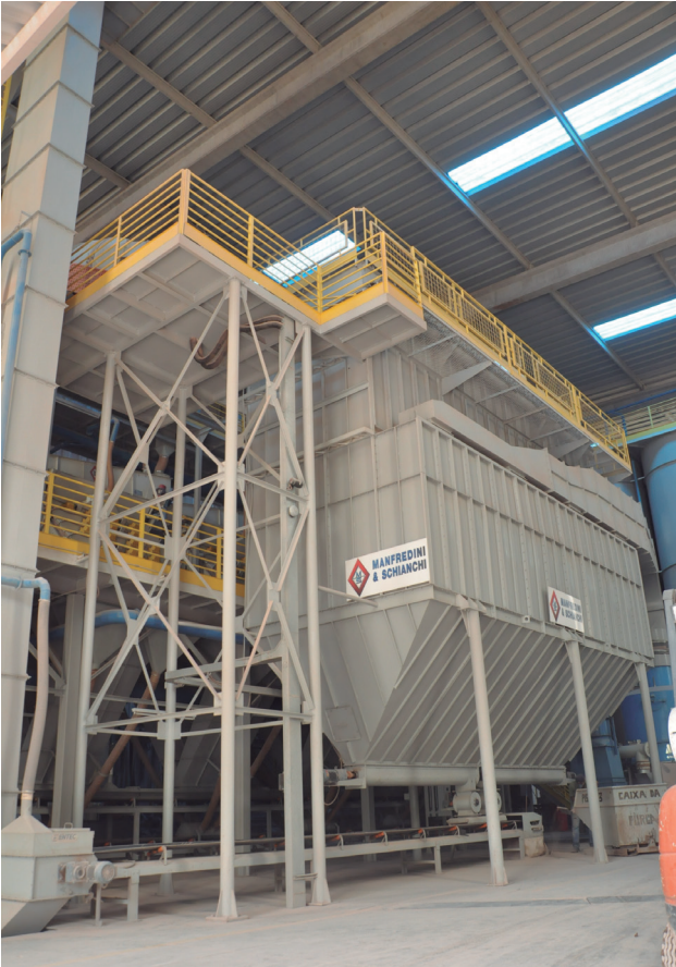
Figura 4.7 – Silo para armazenamento de argila moída. Fotografia: ASPACER, 2013.
