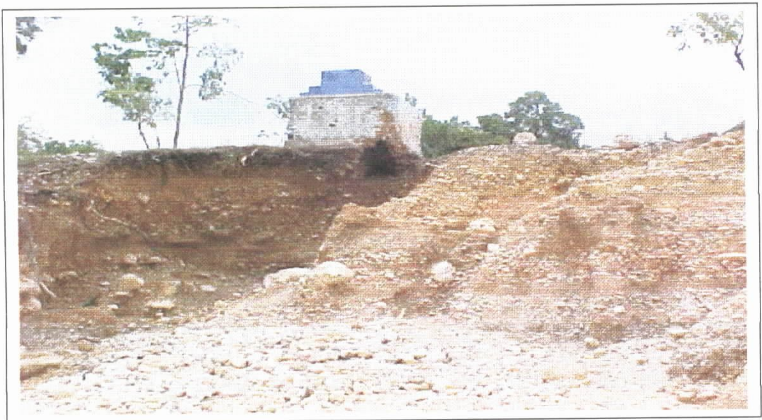
Destruição da margem da ravina, provocada pela erosão resultante da ação das águas carregadas de sedimentos
