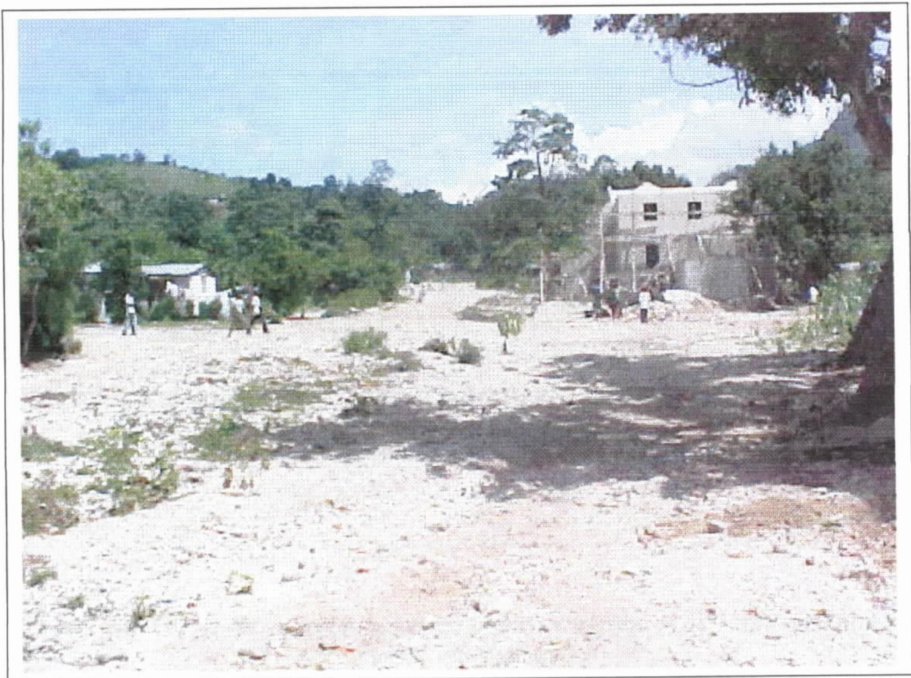
Fora da Ravina de "Gros Cheval", as construções e as ruas localizadas na margem direita também foram afetadas pela enxurrada, uma vez que se encontravam na planície de inundação.
