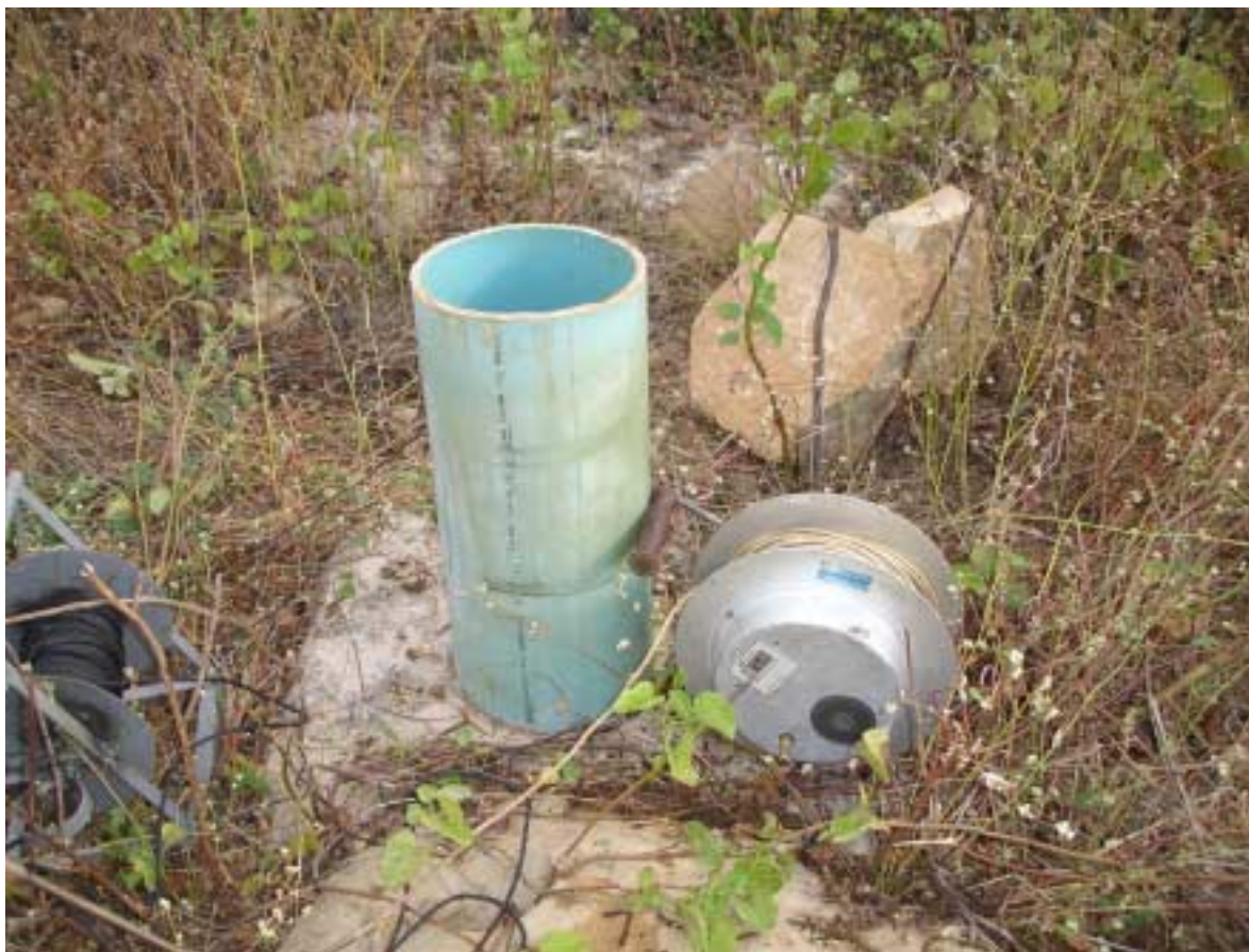
Foto 5.1 - Diagnóstico técnico do poço Mato Alto II
