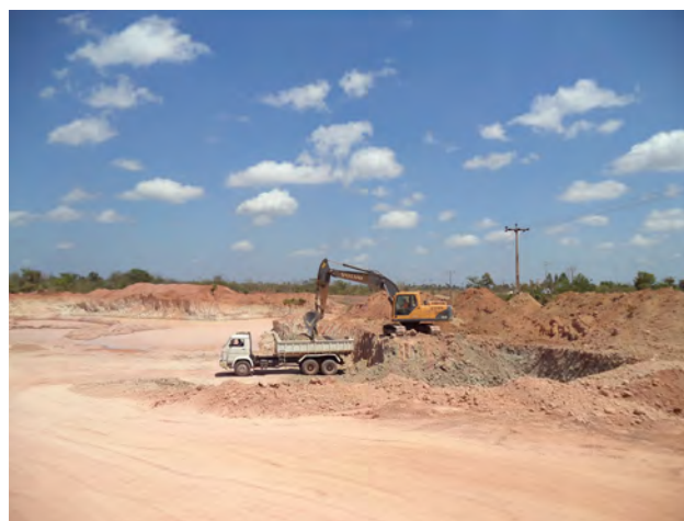
Foto 6.13 – Vista de uma extração de argila por desmonte mecânico e posterior carregamento em caminhão basculante (Afloramento LL 087)
