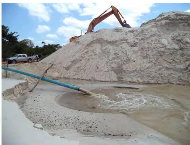
Foto 6.10 – Conductor que transporta o material da polpa até o depósito nas margens (Afloramento LL 056).
