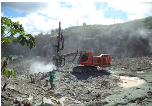
Foto 7.7 – Bancada alta para extração de rocha para brita, em frente de lavra, com uso de explosivos, além de perfuratrizes pneumáticas. Nota-se a total modificação da topografia e perda da harmonia paisagística com a geração de impacto visual. Município de Bacabeira (Afloramento LL 021).
