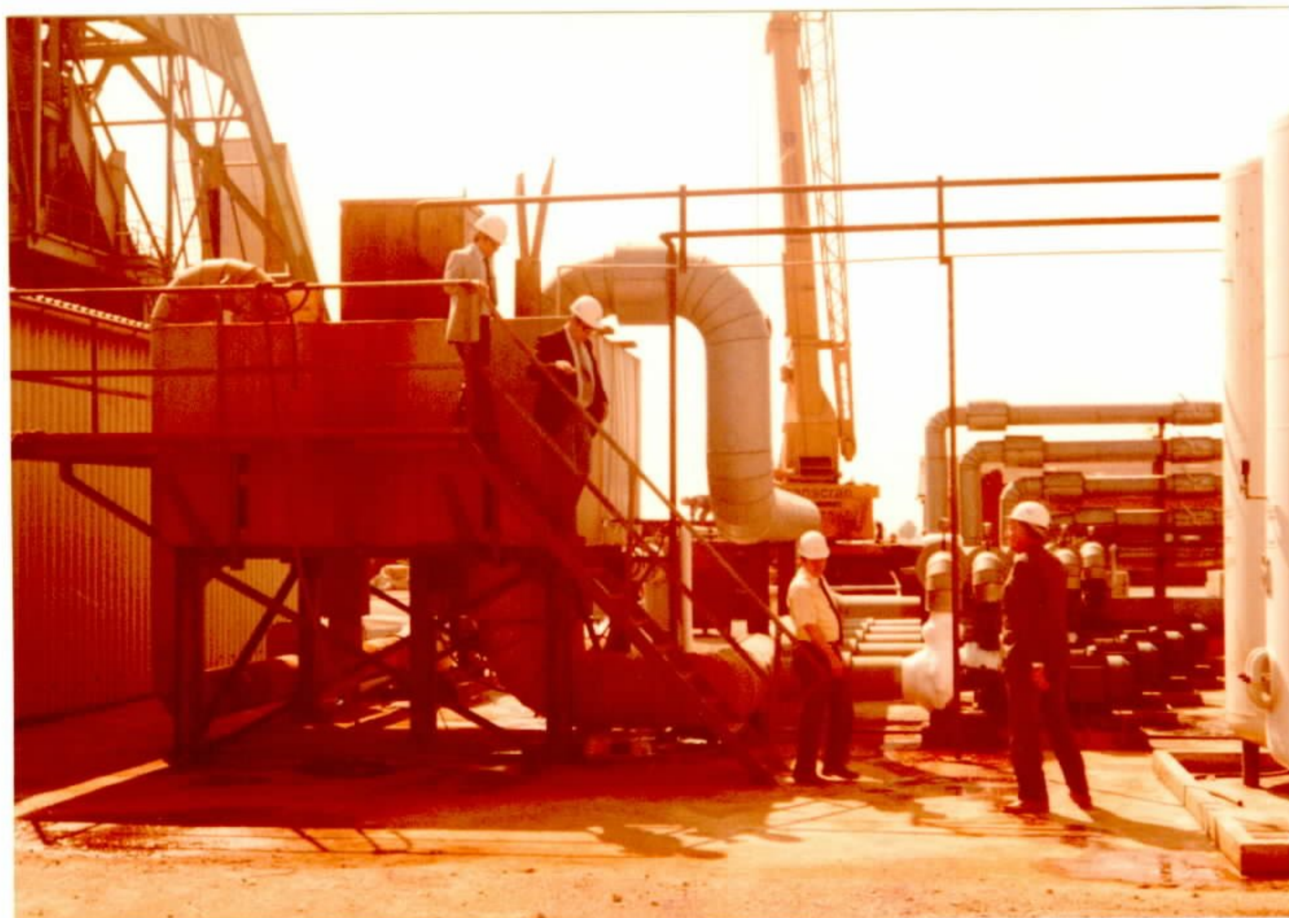
Foto 10 - Instalações de bombeamento do fluido congelante
