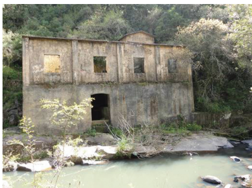
Figura 96: Ruínas da casa de máquinas da hidrelétrica. Fotografia: Carlos Peixoto, 2013.
