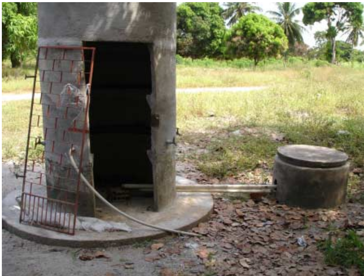
Foto 5.1 - Diagnóstico técnico do poço do Sítio Alagadiço Seco
