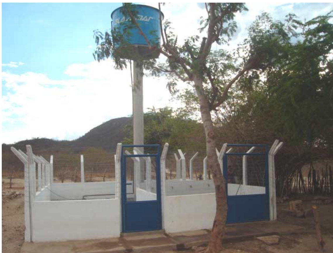
Foto 7.1 - Aspecto do SSA Sítio Novo concluído
