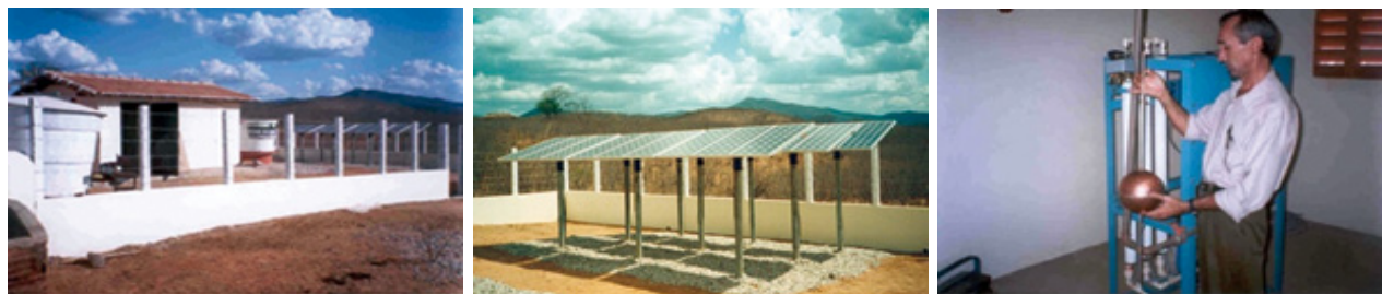
Figura 1 – Estação experimental de energia solar de corrente contínua para bombeamento e dessalinização de água subterrânea, na região de Livramento, município de Irauçuba, Ceará.
