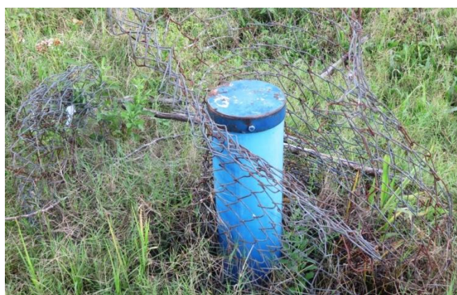
Figura 2.18 - Poço tubular no Sítio Gravatá abandonado por causa da vazão baixa.
