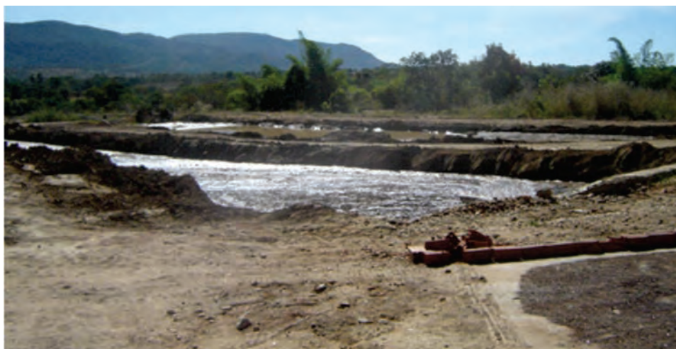
Fotografia 7.33 – Tanque de decantação dos resíduos sólidos e reciclagem da água da usina de beneficiamento de zirconita.
