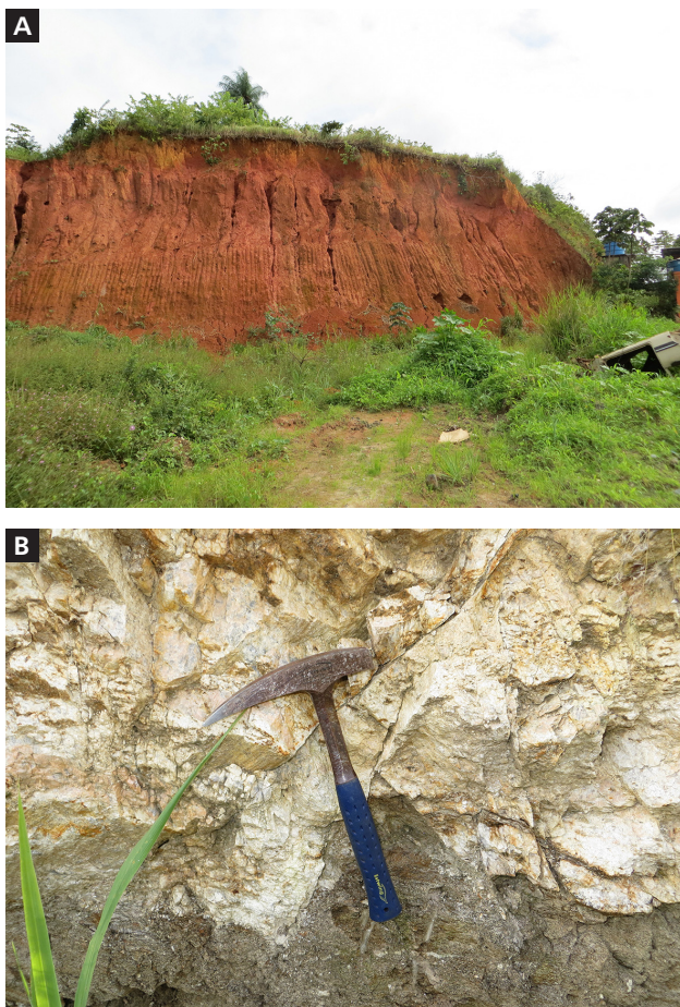
Figura 3.16: A) Perfil de solo antropizado e espesso pacote de solo saprolítico nas proximidades do entroncamento entre a PE-05 e a BR-408. B) Saprolito de rocha gnáissica nas proximidades da linha férrea em São Lourenço da Mata. Foto: Arquivo do projeto, 2018.
