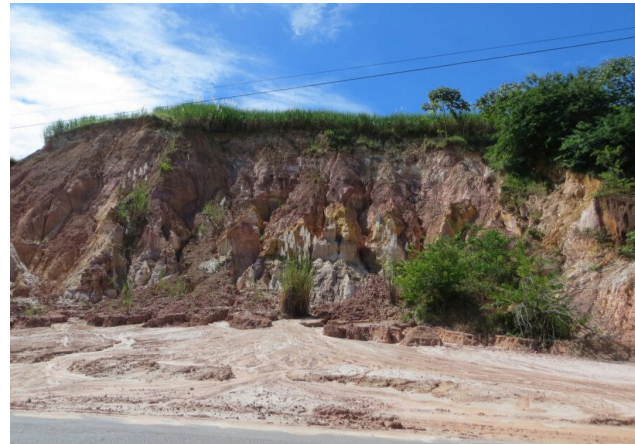
Figura 3.65: Colinas e talude - corte de estrada fortemente erodido, município de Ipojuca. Foto: Arquivo do projeto Mapa Geodiversidade da Região Metropolitana do Recife-RMR, 2018.
