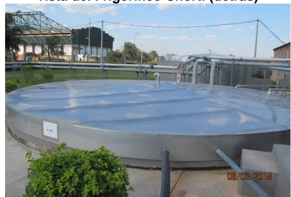
Cisterna de agua tratada y vista del Frigorífico Chorti (detrás)
