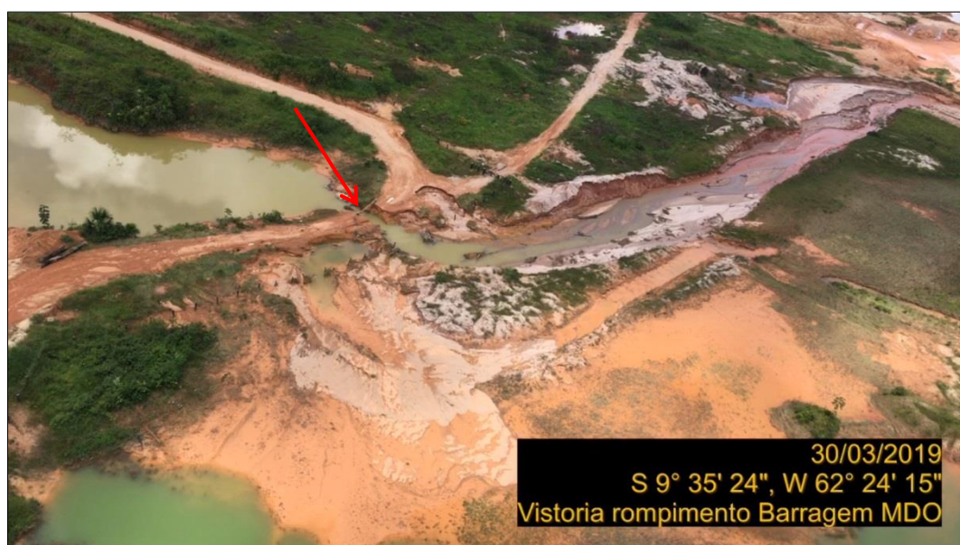
Figura 7. Ponto 02: Rompimento mais a jusante, RO-255. Fonte: Vídeo obtido pela SEDAM dia 30/03/2019.
