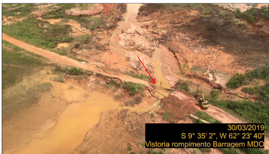
Figura 6. Ponto 01: Rompimento mais a montante. Fonte: Vídeo obtido pela SEDAM dia 30/03/2019.
