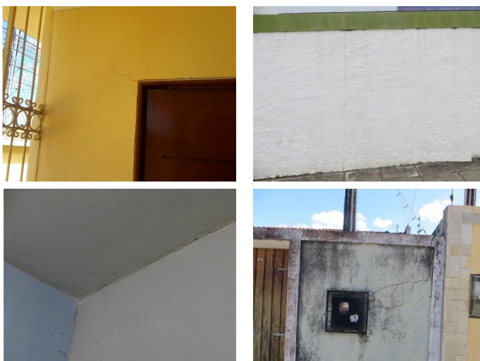
Figura 6. Características das trincas que retratam a área de baixa instabilidade no terreno
