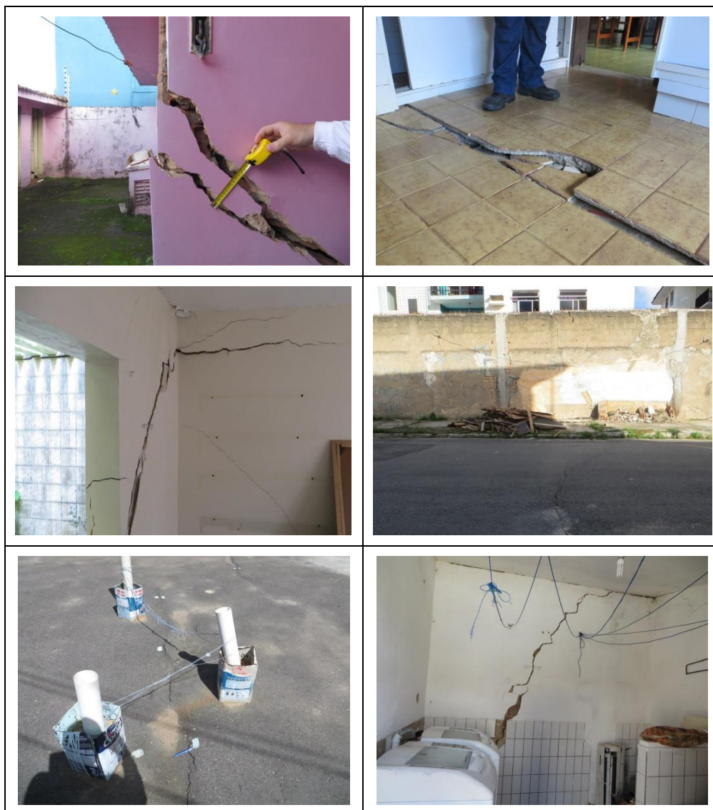
Figura 4. Características das trincas que retratam a área de alta instabilidade no terreno
