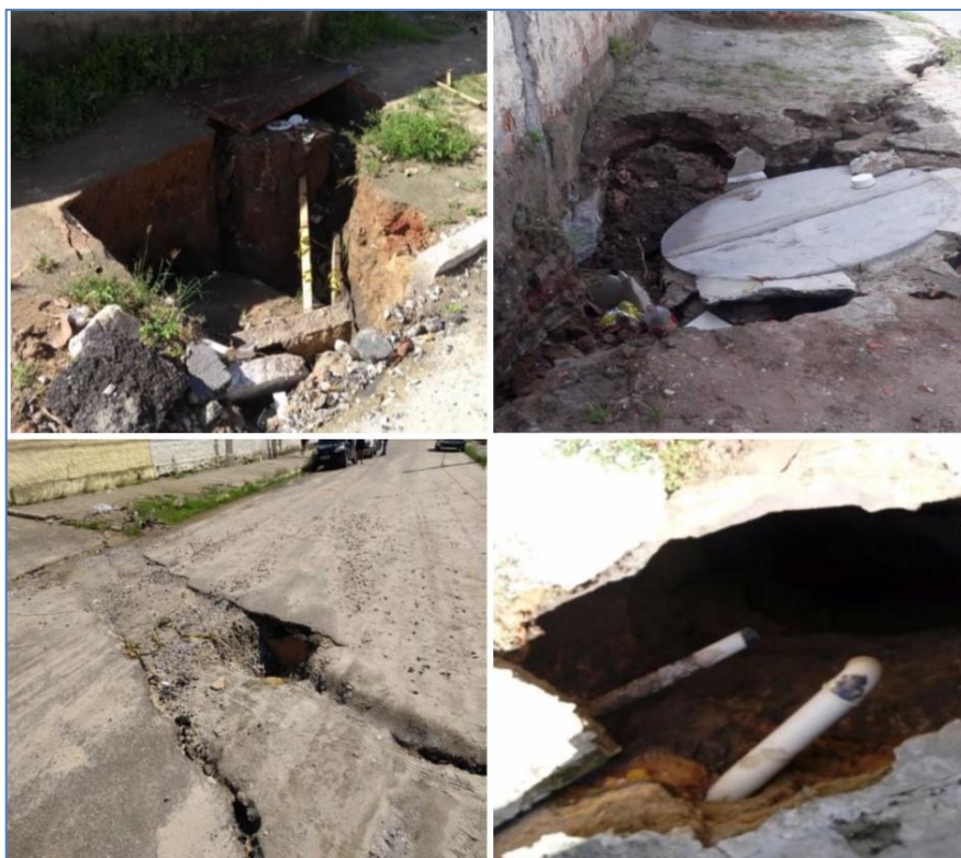
Figura 9. Surgimento de buracos e erosões de pequeno a médio porte nas vias (fotos retiradas do relatório preliminar da Defesa Civil de Alagoas).
