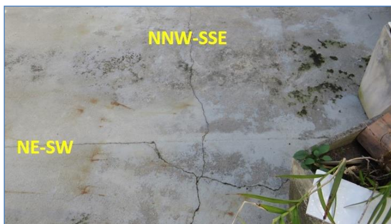
Figura 7. Trincas com orientações distintas, principal (NNW-SSE) e secundária (NE-SW). (para identificação dos padrões regionais, levou-se em conta apenas aquelas direções espacialmente persistentes)
