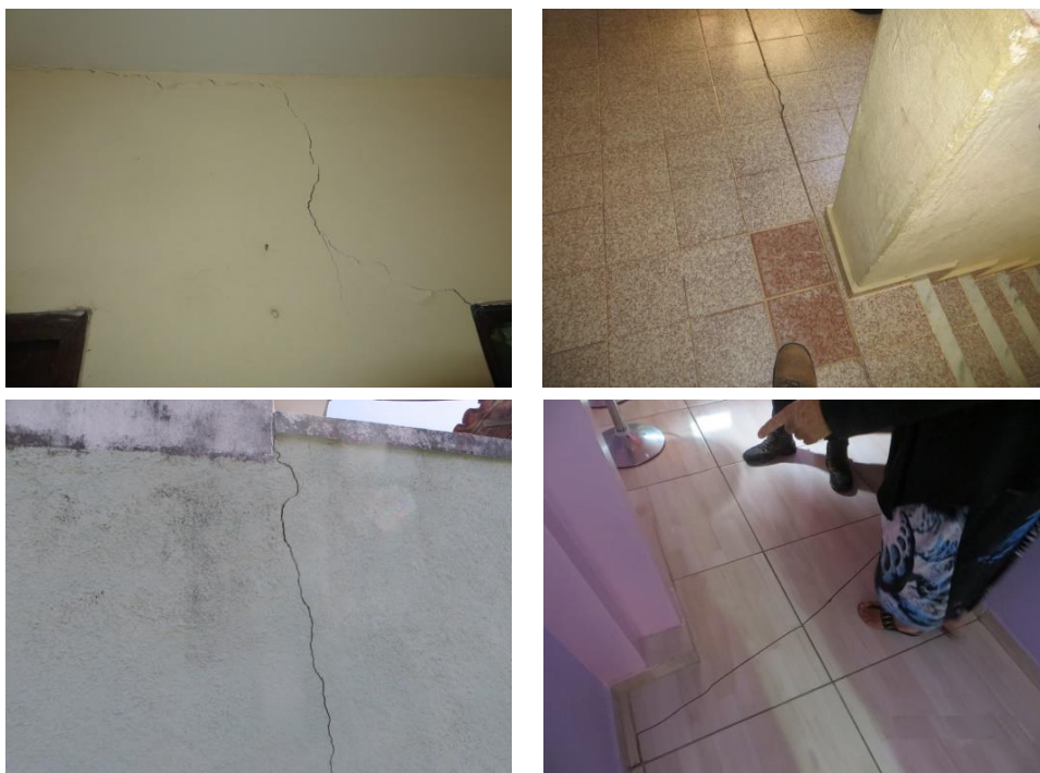
Figura 5. Características das trincas que retratam a área de média instabilidade no terreno
