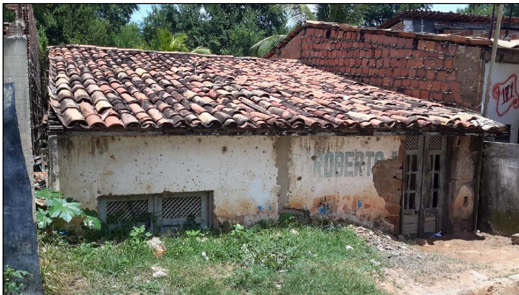
Figura 02: Antiga casa construída sobre solos moles de mangue, em lento processo de afundamento. Vila Santo Amaro, Bebedouro.
