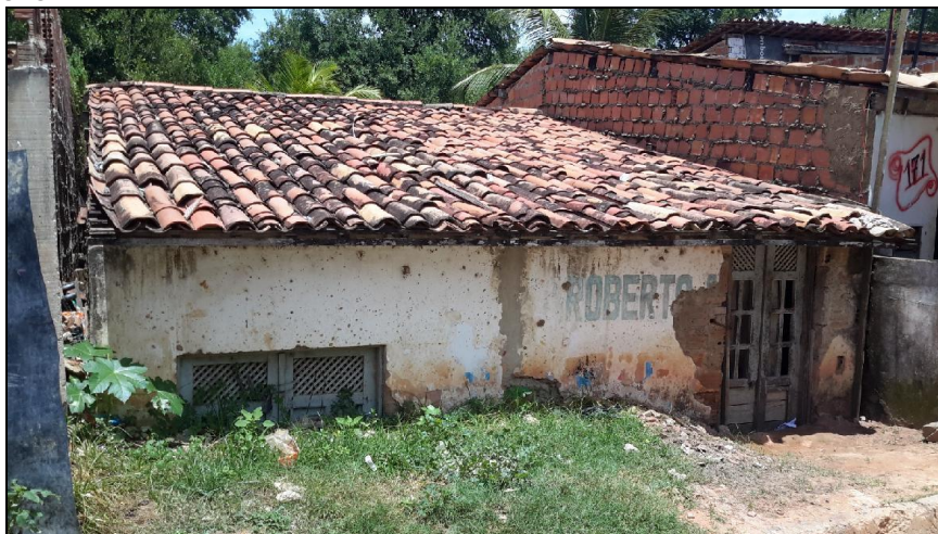
Figura 08. Antiga casa construída sobre solos moles de mangue, em lento processo de afundamento. Vila Santo Amaro, Bebedouro.
