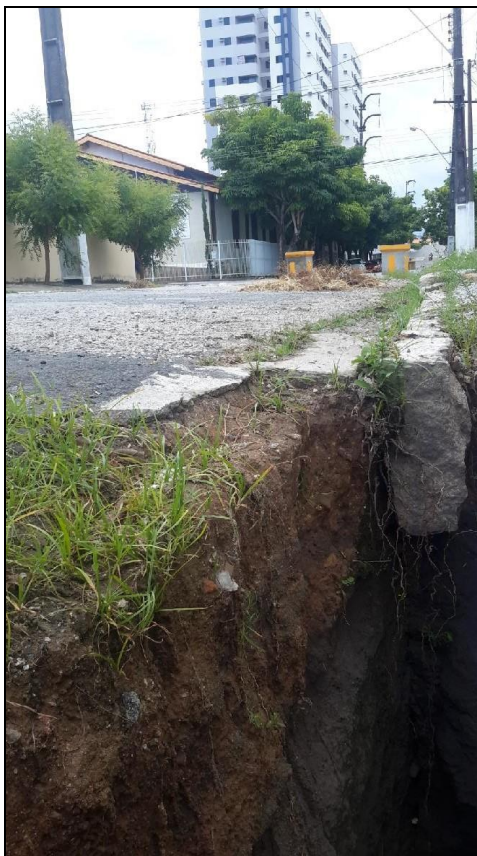
Figura 08: Fenda erosiva em fundo da área abaciada junto à Igreja Menino Jesus de Praga com exposição de aterro (em cor bruno-avermelhada) e solos hidromórficos de ambiente redutor, em cor acinzentada.
