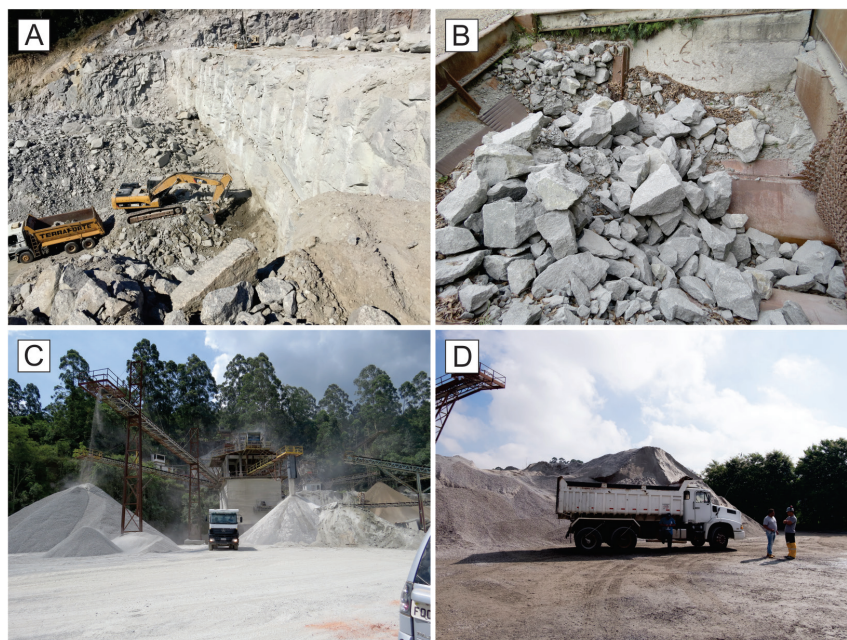
Figura 6.5 - (A) Carregamento de blocos de rocha em caminhão, após desmonte, com auxílio de retroescavadeira; (B) Blocos de rocha no britador; (C) Formação de pilhas de brita com frações granulométricas predeterminadas; (D) Caminhão para transporte de brita ao lado de pilha. O carregamento do caminhão é realizado por retroescavadeiras.
