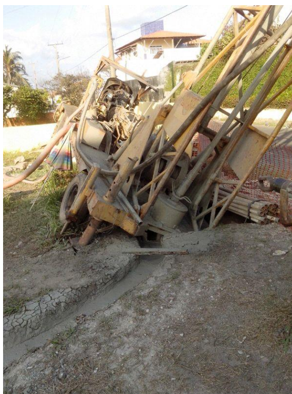
Figura 4. 3 – Perfuratriz rotativa tombada em função da queda da composição do poço provavelmente por ocorrência de conduto cárstico (caverna).
