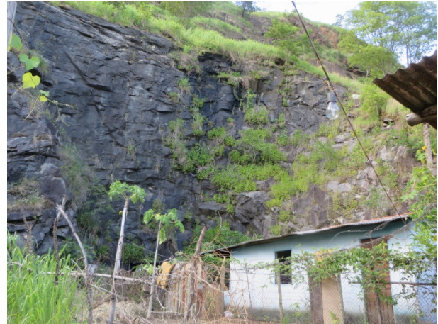
Figura 5. Moradia de baixo padrão construtivo na base do paredão rochoso (face da pedreira abandonada) em risco a queda de blocos.
