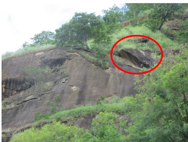
Figura 9. Descontinuidades com raízes de vegetação na face natural do paredão rochoso. Observa-se uma porção do maciço onde já ocorreu a mobilização de bloco rochoso (destacado em vermelho).
