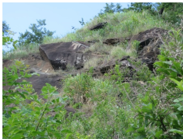
Figura 15: Ponto 6 - Tela que engloba bloco fraturado com finalidade de impedir a queda de lascas e blocos.
