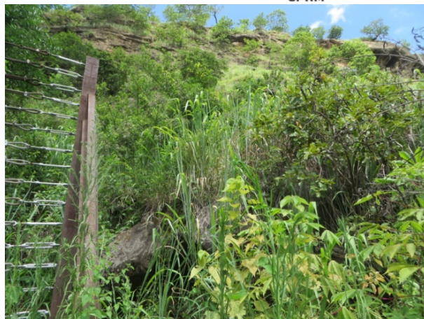
Figura 18: Ponto 7 - Ponto em que foram interrompidas as obras de contenção.
