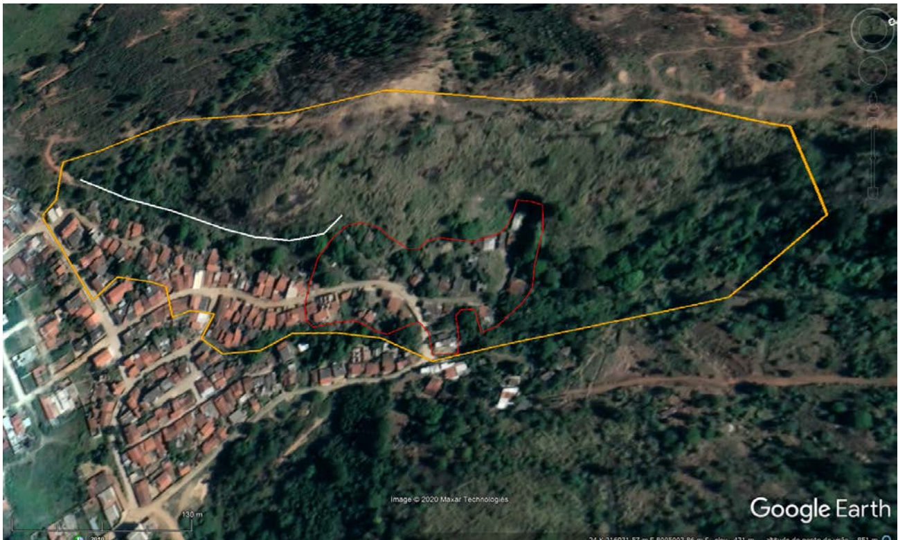
Figura 1. Vista do setor MG_ITA_SR_08_CPRM (em laranja). A área delimitada em vermelho indica a porção do setor onde nenhuma medida de mitigação do risco a queda de blocos foi implantada. A linha branca representa a localização aproximada da cerca. Imagem: Google Earth.
