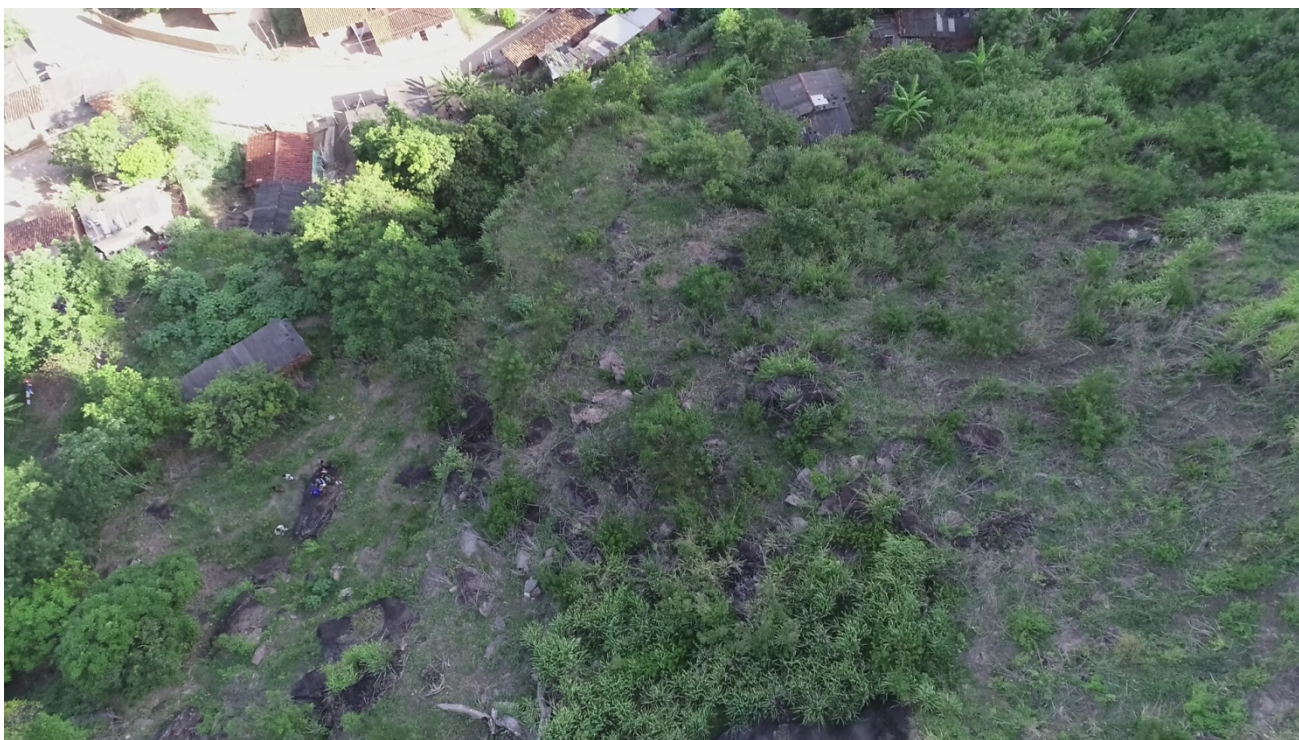
Figura 3. Vista do alto da encosta e das moradias em sua base sujeitas a risco de queda de blocos. Detalhes de blocos soltos na face da encosta.
