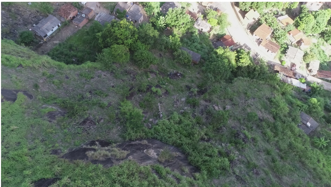
Figura 2. Vista do alto da encosta e das moradias em sua base sujeitas a risco de queda de blocos.
