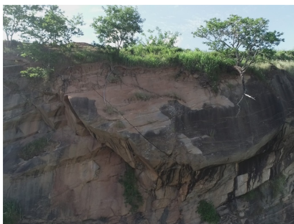
Figura 10. Descontinuidades com raízes de vegetação na descontinuidade do maciço rochoso. Observa-se que já ocorreu a mobilização de um bloco rochoso.
