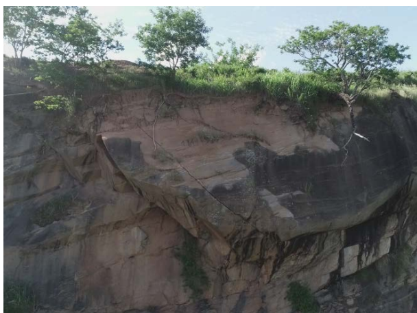
Figura 19: Ponto 9 - Maciço com fraturas preenchidas por solo e com marcas que indicam percolação de água nas discontinuidades.
