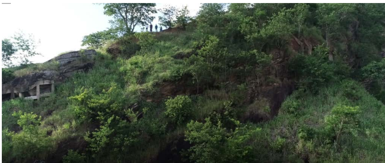
Figura 16: Pontos 3 e 4 – Ancoragem em blocos rochosos próximo ao topo do maciço.
