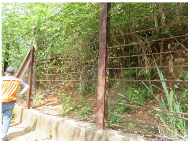
Figura 14: Ponto 2 – Cerca, parcialmente deteriorada, construída com objetivo de conter ou reduzir o movimento de blocos.
