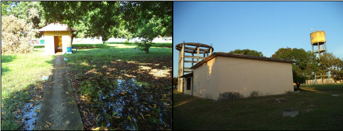
Figura 9: À esquerda, água de vazamento do reservatório de ferro acumulada no entorno do poço PT-10; à direita, vista de dois reservatórios de concreto, sem utilização, existentes no terreno do bombeamento II.
