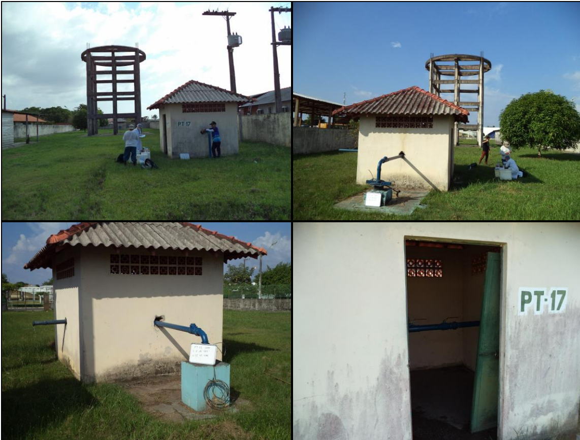
Figura 13: Acima, vistas de frente e de fundo do terreno da Estação de Bombeamento IV, onde se observa “esqueleto” de reservatório inacabado; abaixo, poço PT-17, com vazamento na tubulação de retorno e sem porta na casa de comando da bomba.
