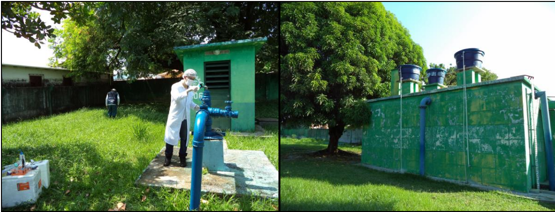
Figura 5: Terreno da Estação de Bombeamento I, na rua Paraíba, com vista do poço PT-06 e do reservatório de concreto com as caixas azuis de fibra onde é feita a dosagem de cloro.
