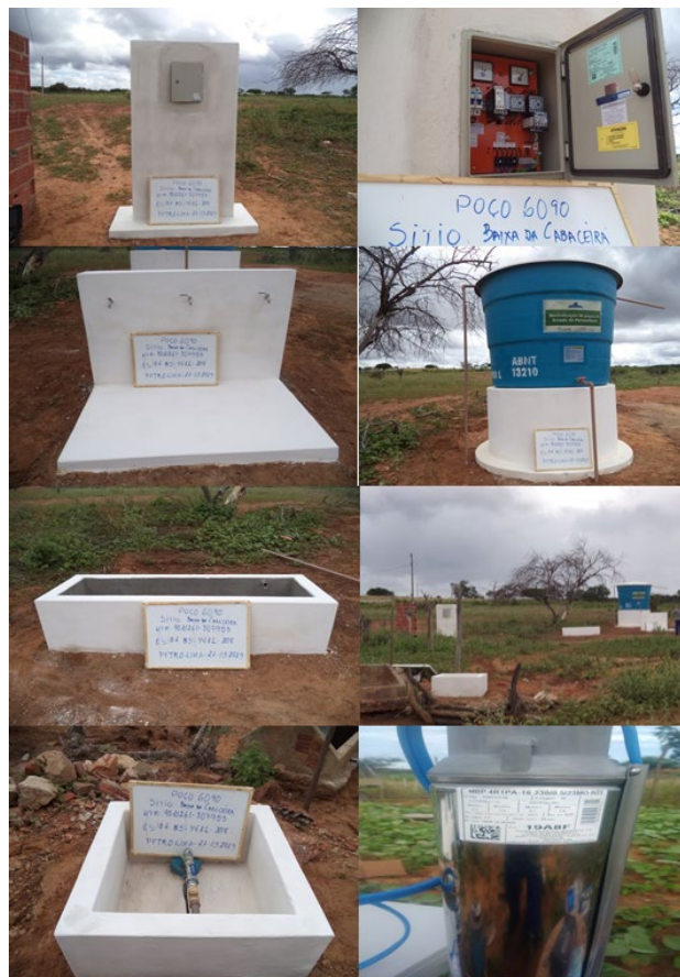
Foto 02 – Exemplo de instalação de poço com bomba submersa. Poço 06090 – Localidade Sítio Baixa da Cabeceira, Petrolina/PE.
