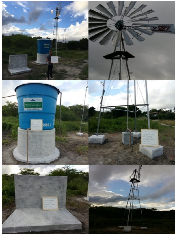
Foto 01 – Exemplo de instalação de poço com cata-vento. Poço 87003 – Localidade Sussuarana, Santa Maria do Cambucá/PE.
