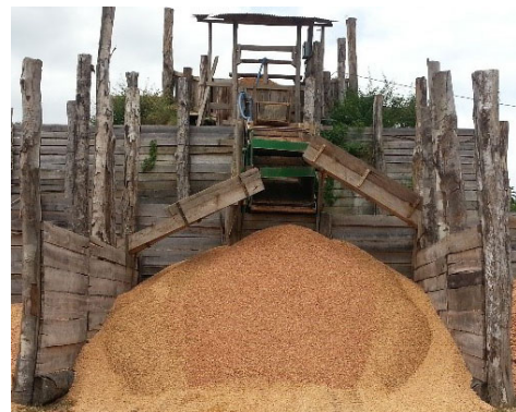
Figura 5.19 - Vista frontal de área de beneficiamento (sem o “silo”), mostrando o sistema de peneiras e o material britado já selecionado. Fonte: Fotografia do Arquivo da SEDEME.
