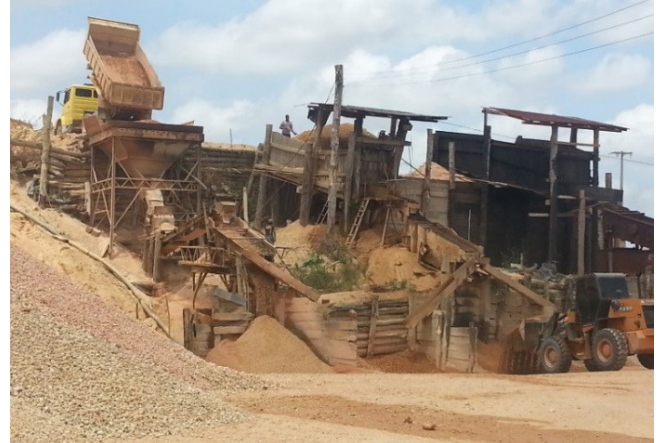
Figura 5.17 - Conjunto de equipamentos da área de beneficiamento utilizado em lavras visitadas no projeto. Fonte: Fotografia do Arquivo da SEDEME.
