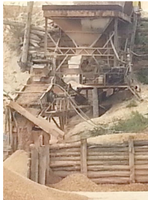
Figura 5.18 - Detalhe da foto anterior, mostrando o “silo e o conjunto de peneiras que compõem a planta de beneficiamento onde é processada a classificação (peneiramento) do minério.
