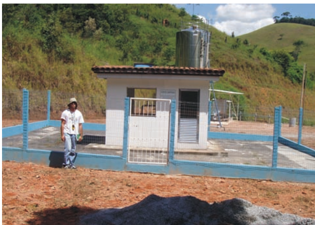
Figura 7.1 – Poço de captação de água mineral, município de Sumidouro
