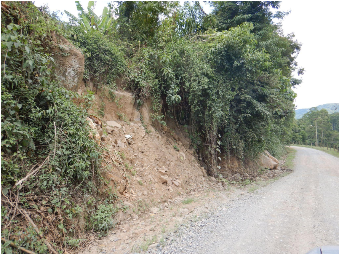
Figura 18: Exemplo de deslizamento planar induzido por atividade antropogênica (Rio do Sul - SC).
