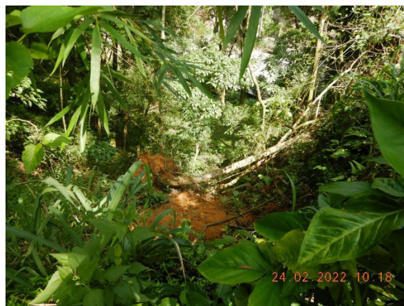
Foto 2b – Vista do deslizamento de cima.
