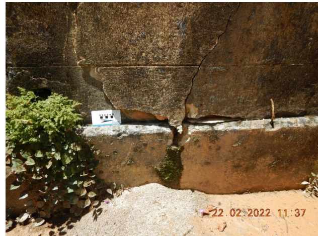
Foto 10 - Fuga de material fino
