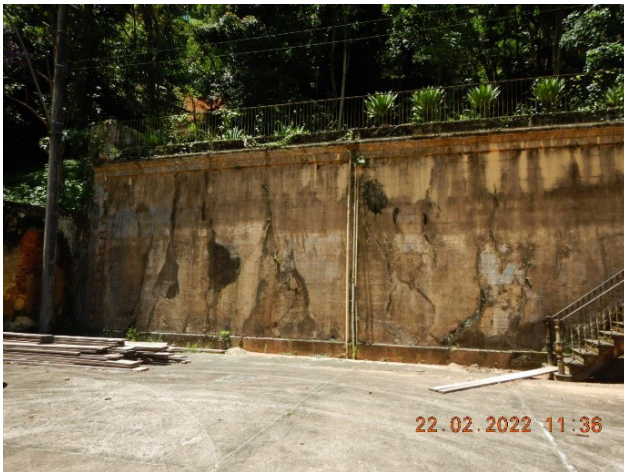
Foto 7 - Muro de contenção trincado
