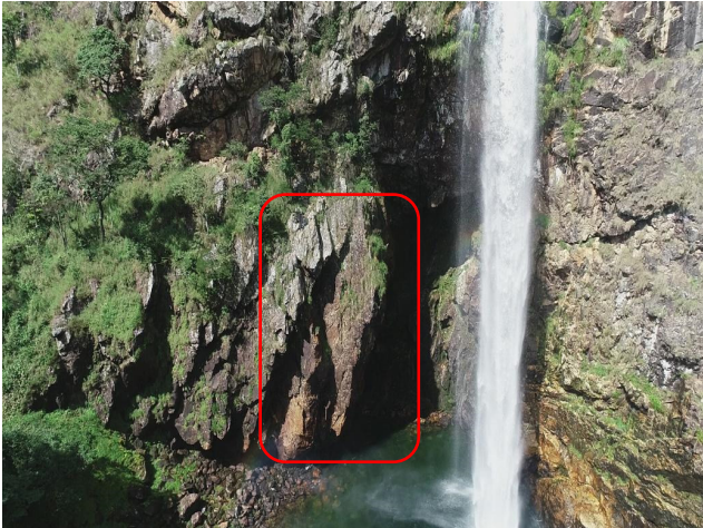
Figura 40 - Detalhe da porção do paredão rochoso, que em função da existência de descontinuidades verticais, apresenta potencial de ocorrência do evento de tombamento rochoso. Fonte: Foto dos autores.
