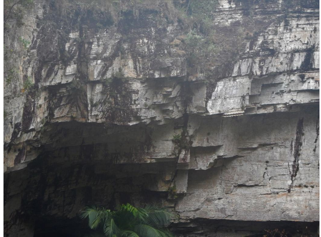
Figura 61 - Detalhe da interseção das fraturas subverticais com o acamamento subhorizontal, que delimitam blocos rochosos, com grande potencial de se desprenderem do teto, atingindo o poço. Fonte: Foto dos autores.
