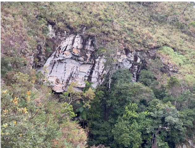
Figura 62 - Detalhe de placas rochosas descalçadas, com grande potencial de quebrarem e atingirem o poço para banho. Fonte: Foto dos autores.
