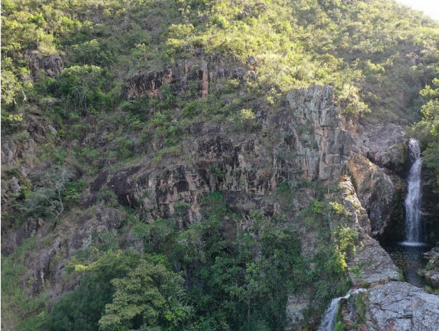
Figura 44 - Vista do drone, da porção superior do maciço rochoso, com planos de fratura subverticais e acamamento subhorizontais, os quais delimitam blocos rochosos de dimensões métricas, com alto potencial de queda. Fonte: Foto dos autores.
