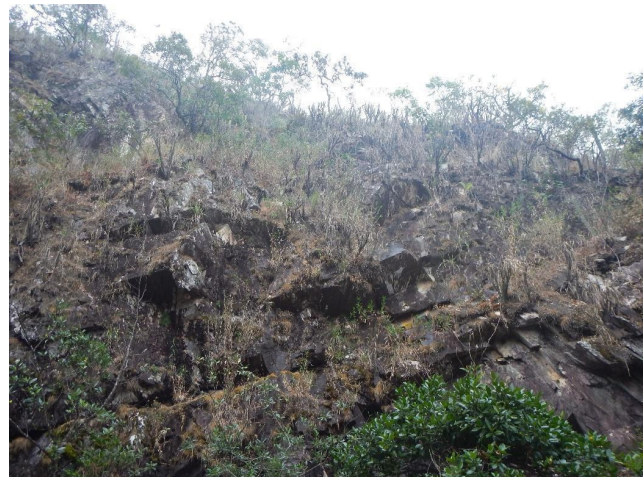
Figura 55 - Detalhe de blocos rochosos descalçados, com potencial de queda e atingimento da área de visitação e poço da cachoeira Vai quem Pode. Fonte: Foto dos autores.
