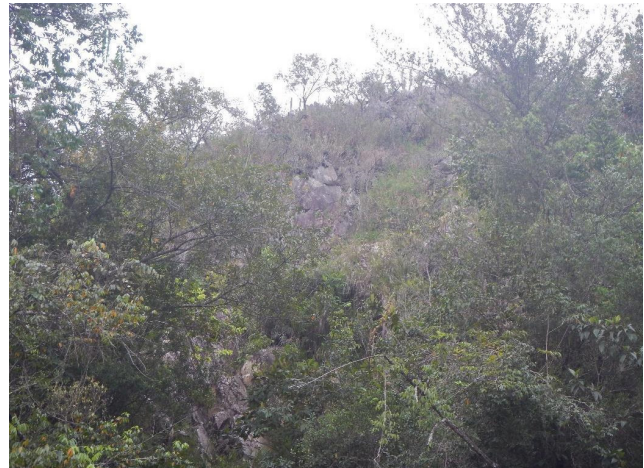
Figura 51 - Vista das encostas adjacentes a cachoeira e poço para banho, contento blocos rochosos no paredão, e eventualmente soltos, os quais podem se movimentar e atingir a área do atrativo turístico. Fonte: Foto dos autores.
