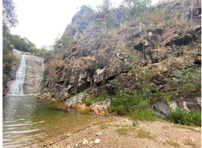
Figura 53 - Paredão rochoso com fraturas subhorizontais e subverticais, que delimitam blocos rochosos centimétricos a métricos, com grande potencial de queda na área de visitação da cachoeira. Fonte: Foto dos autores.
