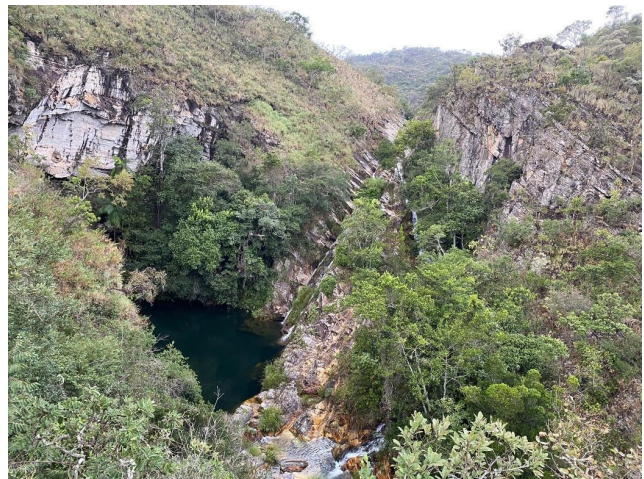
Figura 63 - Vista do drone das áreas adjacentes ao poço para banho da cachoeira Coqueirinhos, com vegetação densa que pode esconder blocos soltos, com potencial de se movimentarem a atingirem a área de visitação turística. Fonte: Foto dos autores.
