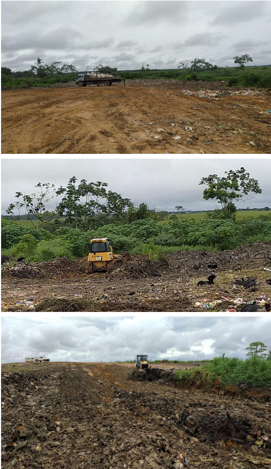
Figura 2 - Aspectos da atual lixeira municipal de Guajará, com destaque para a cobertura dos resíduos feita com trator de esteira, o que impede grande proliferação de urubus.
