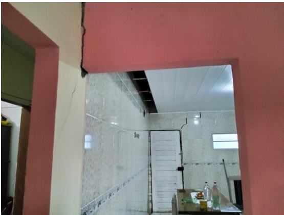
Figura 3 - Rachaduras em imóvel. Setor 4.
