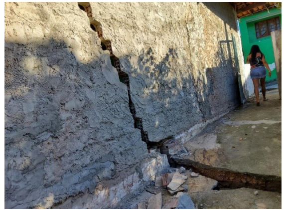
Figura 4 - Degrau de abatimento no piso que danificou moradia. Setor 3.
