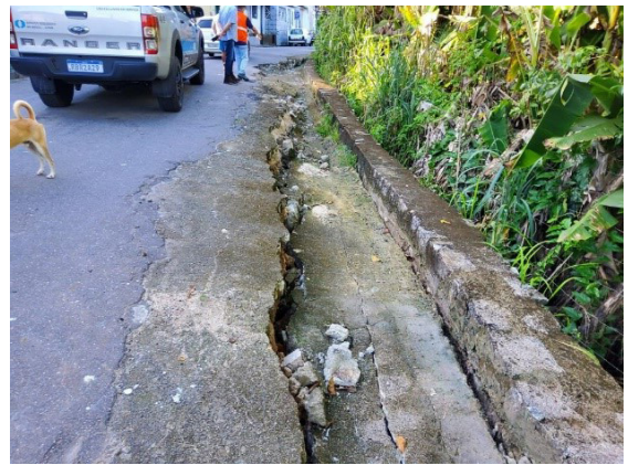
Figura 6 - Degrau de abatimento na rua Dr. Antônio Cansação. Setor 3.
