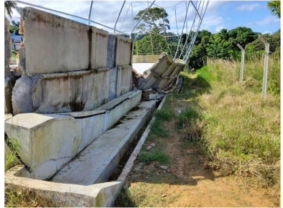
Figura 2 - Detalhe da parede da quadra de esportes tombada. Setor 2.
