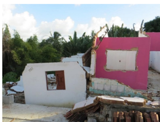
Figura 10 - Residências destruídas pelas rupturas no solo no bairro Alto da Rosa (CPRM, 2017).
