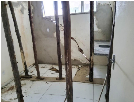
Figura 5 - Paredes do posto de saúde escoradas para evitar acidentes. Setor 2.
