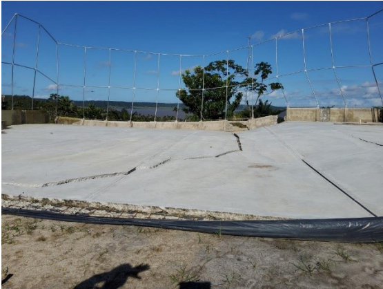
Figura 1 - Danos na quadra de esportes em construção. Setor 2.
