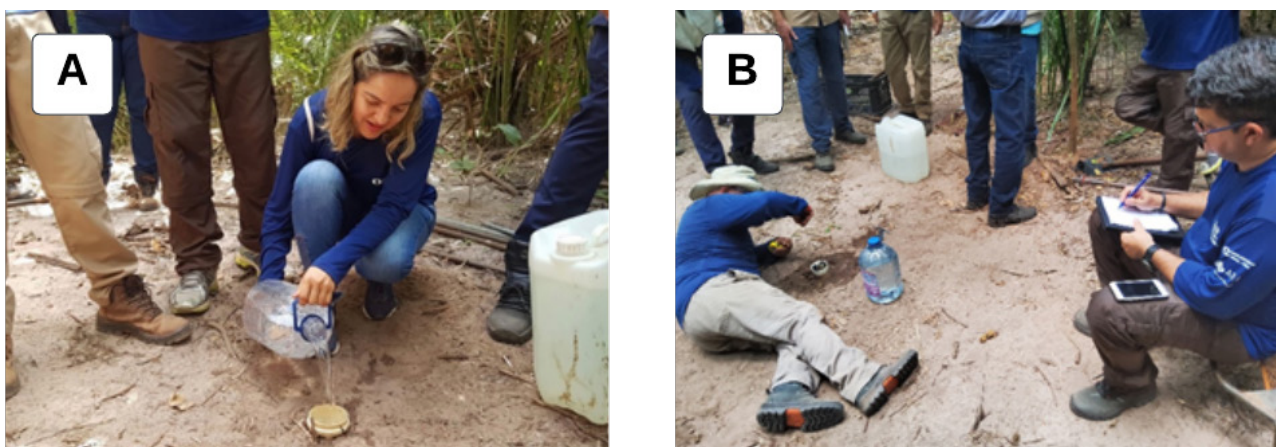
Figura 05 - Instalados os tubos de PVC nos furos, deve-se: (A) preencher com terra o espaço anelar entre o tubo e as paredes do furo, evitando que parte da terra caia dentro do tubo, (B) compactar a terra do espaço anelar para evitar que o tubo se mova durante o teste. Fonte: os autores.
