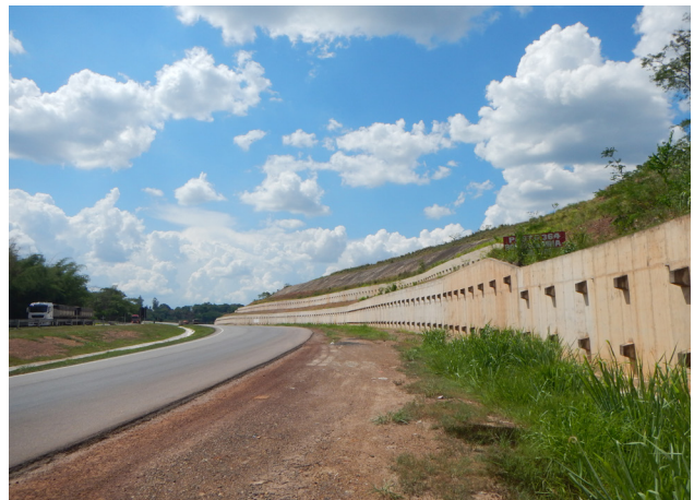
Figura 4.36: Corte de estrada realizado na unidade DSVMPsaa. Foto: Rodrigo Luiz Gallo Fernandes (2022).
