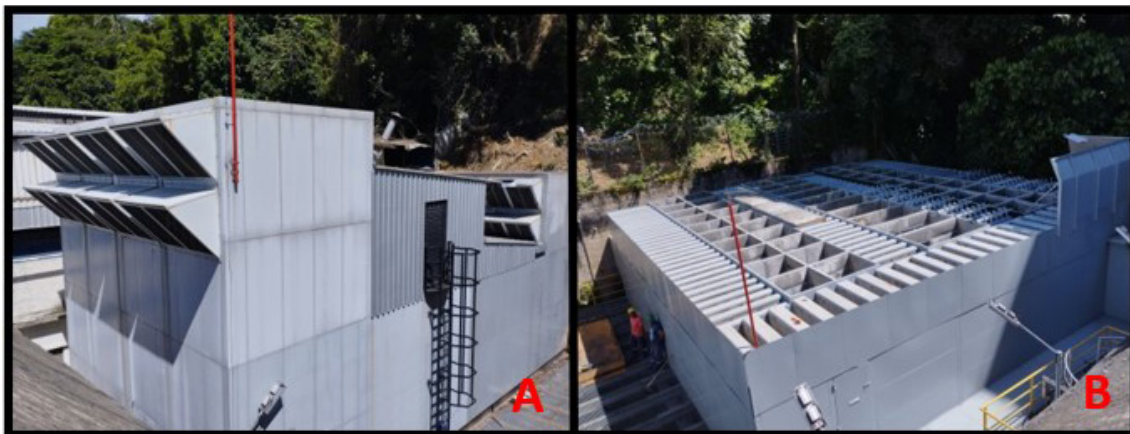
Figura 3 - Equipamentos da Dataprev próximos a base da encosta parcialmente atingidos pelo deslizamento. A - Casa do gerador. B - Central de resfriamento dos servidores.
