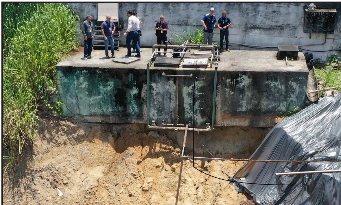
Figura 7 - Parte do aterro sob a caixa d'água deslizou.
