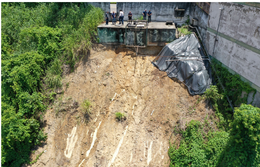
Figura 10 - Material em condição de instabilidade.
