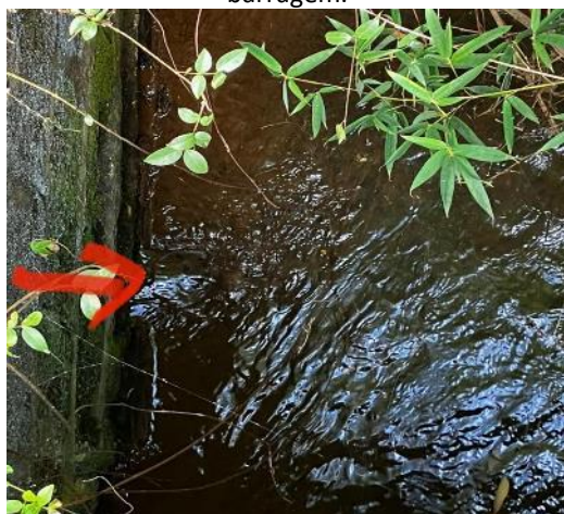
Figura 11. Infiltração de água através de duto erosivo no talude da barragem.
