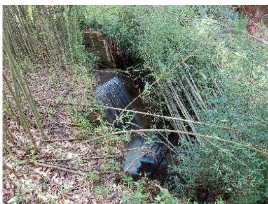
Figura 9. Danos à estrutura construída no talude da barragem.
