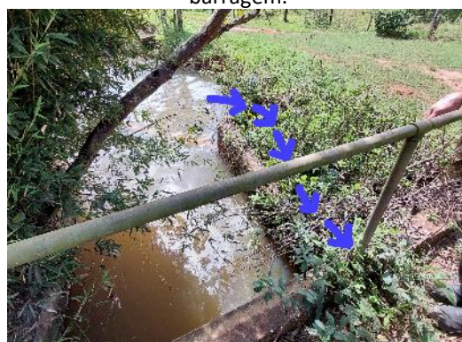
Figura 10. Infiltração de água através de duto erosivo no talude da barragem.
