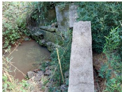
Figura 8. Danos à estrutura construída no talude da barragem.
