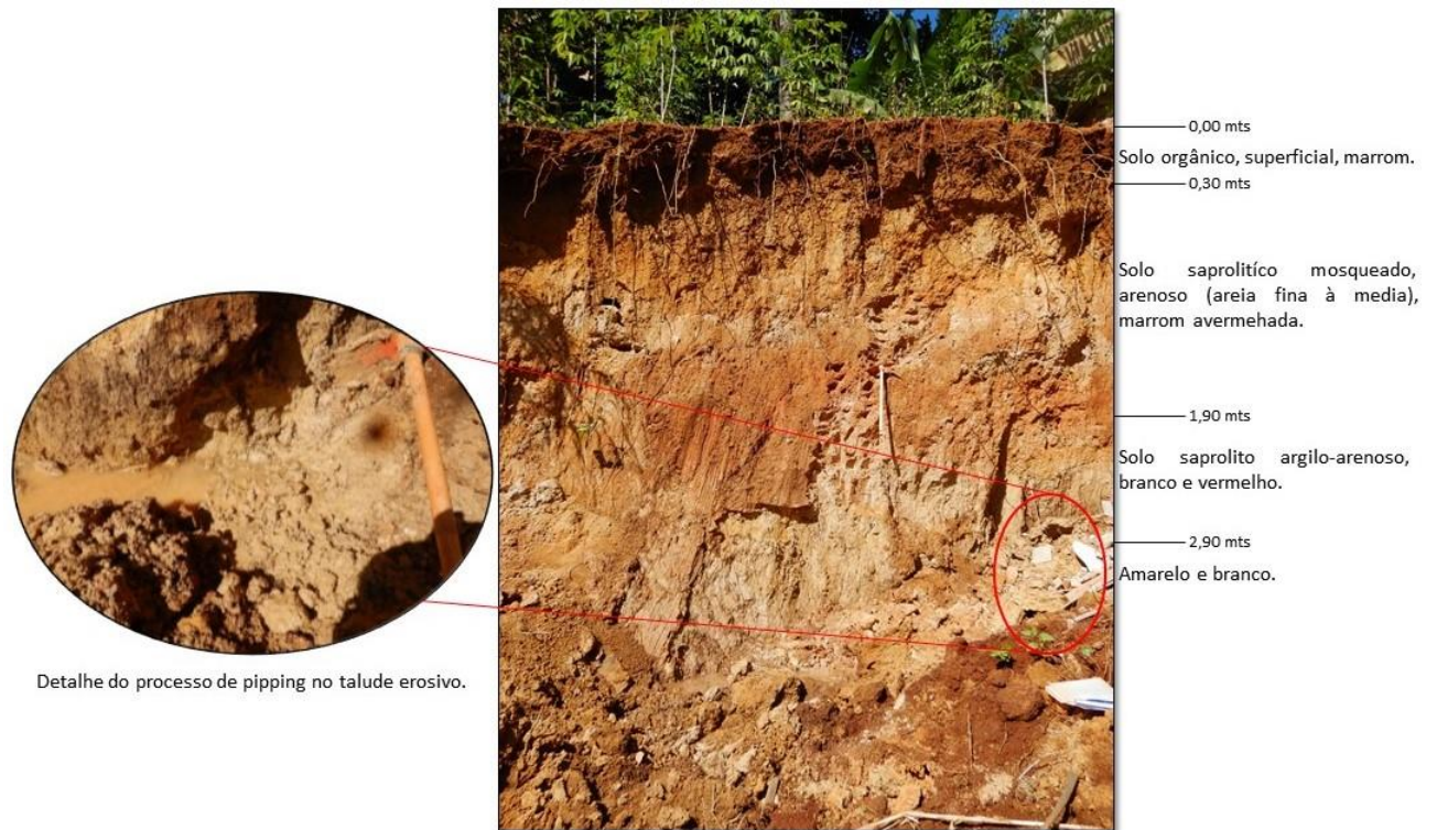
Figura 58 - Perfil dos materiais geológicos associados à erosão 12, com destaque para a ocorrência de pipping no sopé do talude
