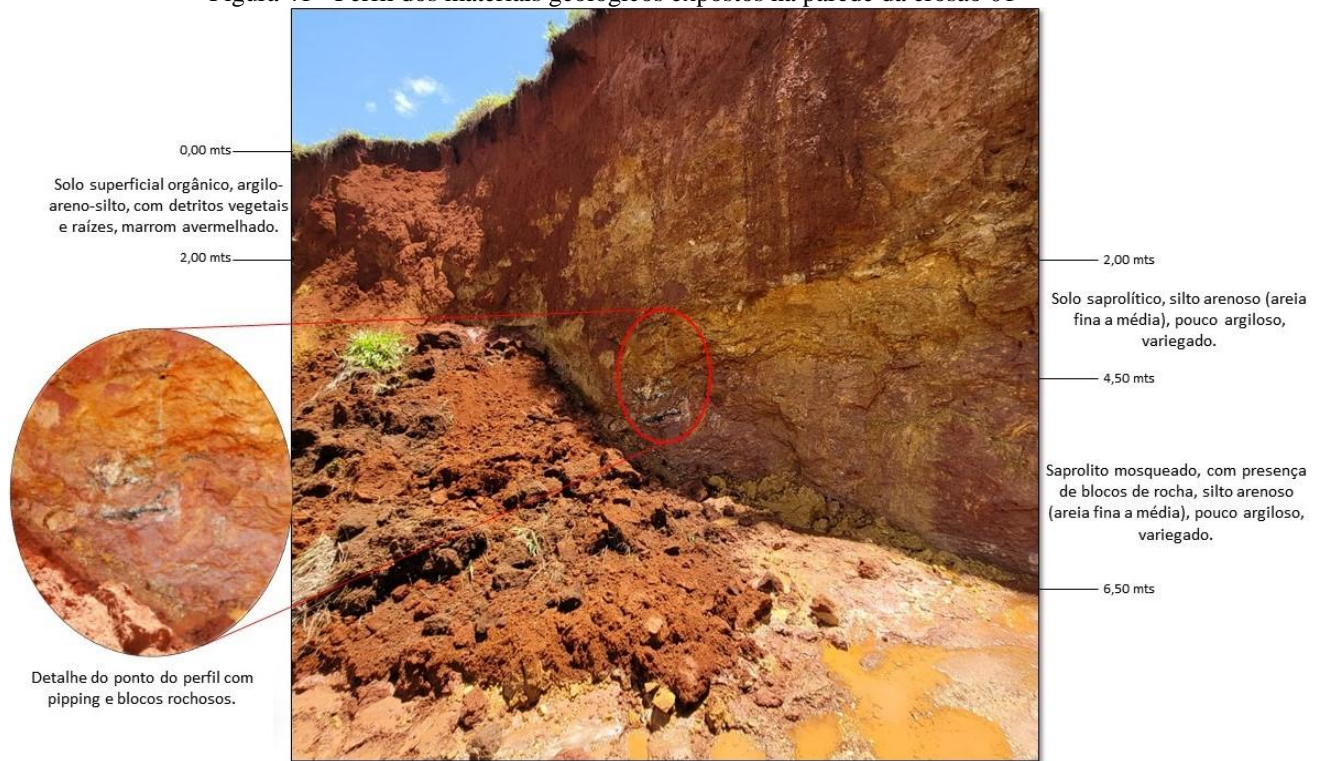
Figura 41 - Perfil dos materiais geológicos expostos na parede da erosão 01
