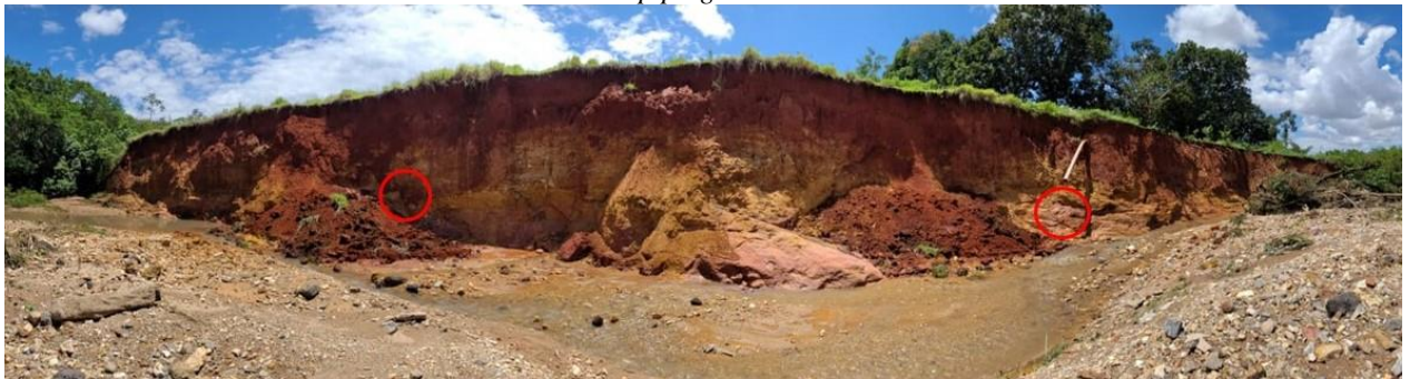
Figura 42 - Vista panorâmica do perfil dos materiais geológicos da erosão 01, com destaque para os pontos de piping
