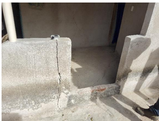
Figura 12 – Trincas com abertura milimétrica nas paredes e no piso de uma das casas da rua São Francisco.
