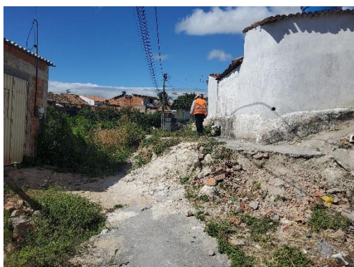
Figura 4 – Feição de movimentação no terreno: degrau de abatimento na rua Vicente Bedeu.
