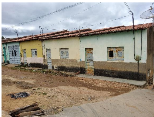
Figura 10 – Casas na rua do Cemitério apresentam numerosas trincas nas paredes e no piso.
