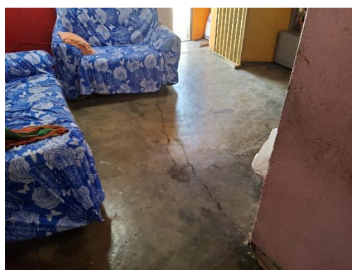
Figura 9 – Trinca persistentes no piso da casa na rua Antonio Tenório. Essa trinca persiste por toda a residência.
