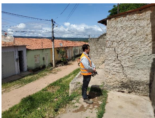
Figura 8 – Trinca marcante no muro da residência na rua do Cemitério.
