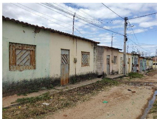
Figura 15 – Lançamento de água servida diretamente no terreno onde já se observam indícios de movimentação (rua do Cemitério). Em geral, todas as casas que aparecem na foto apresentam trincas.
