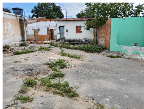
Figura 5 – Feição de movimentação no terreno: trinca persistente no terreno e trinca nas moradias (local: largo próximo à rua Padre Cícero).
