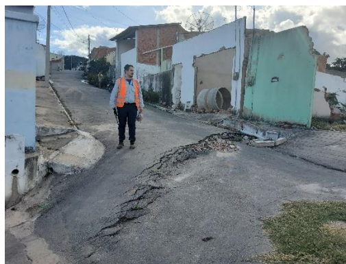
Figura 7 – Feição de movimentação no terreno: degrau de abatimento na rua José Calixto.
