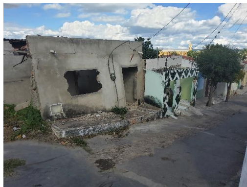
Figura 17 – Alvenarias instáveis que colocam em risco as pessoas que circulam pela rua José Navaro.
