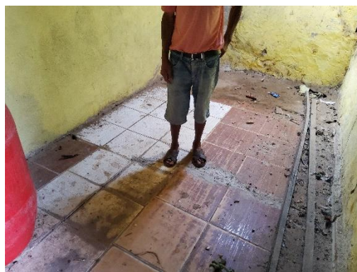
Figura 11 – Abatimento no piso da casa na rua do Cemitério esquina com rua Antônio Tenório.
