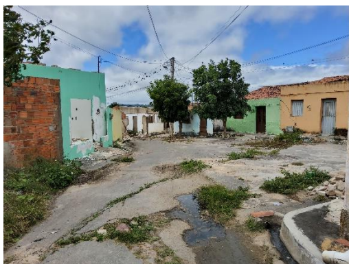
Figura 6 – Feição de movimentação no terreno: trinca persistente no terreno e trinca nas moradias (local: largo próximo à rua Padre Cícero). Observa-se lançamento de água servida diretamente no terreno.
