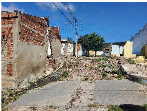
Figura 16 – Alvenarias instáveis que colocam em risco as pessoas que circulam pelo local (Rua Vicente Bedeu).
