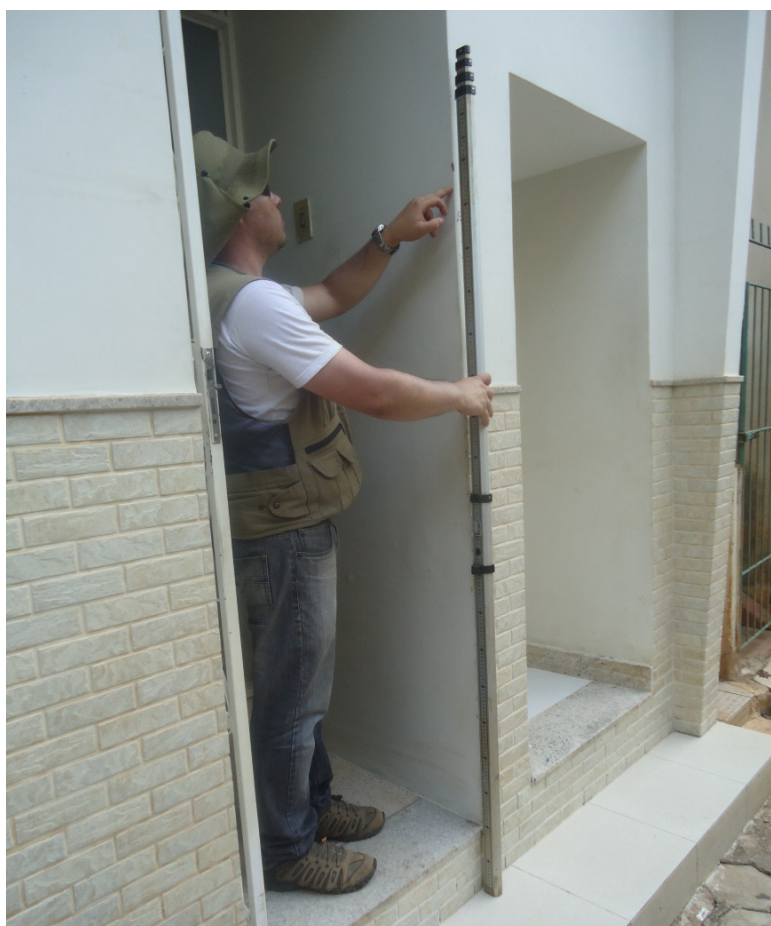
Figura 65 - Levantamento das marcas de cheia da enchente do dia 24-12-2013 Local: Bairro Centro
