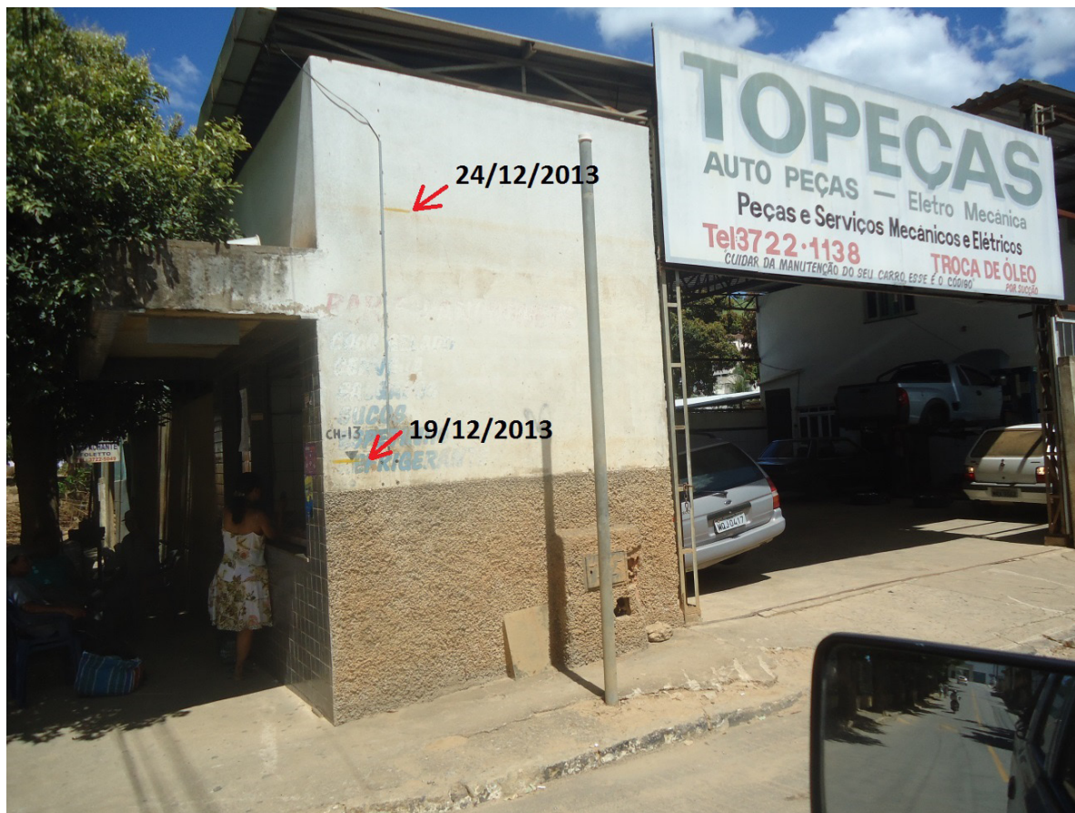
Figura 64 - Marcas de cheias dos eventos dos dias 19 e 24-12-2013 (rio Santa Maria) Local: Bairro Sagrado Coração de Jesus (primeiro ponto que inunda na cidade)
