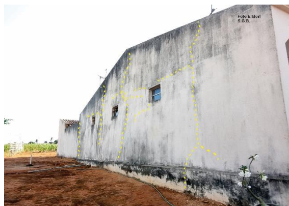
Figura 22 – Imóvel em alvenaria, bem construído, com trincas em suas paredes.
