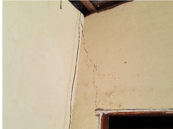
Figura 16 – Trinca localizada na quina de porta da moradia.
