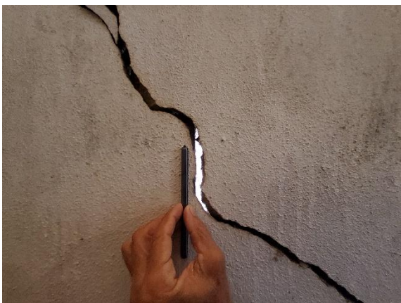
Figura 19 – Rachadura. Notar afastamento entre paredes.
