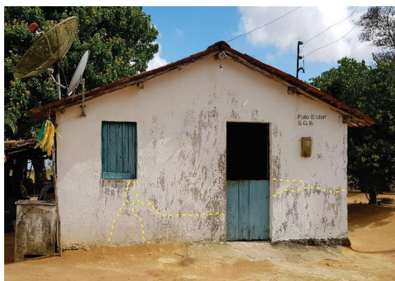
Figura 21 – Imóvel em taipa com trincas em suas paredes.
