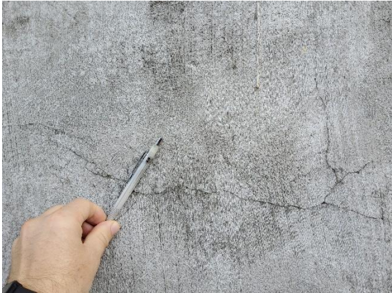
Figura 15 – Fissura em parede.
