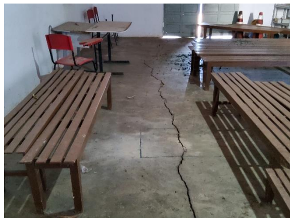
Figura 20 – Rachadura no piso de igreja.
