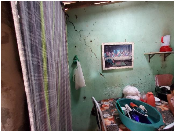
Figura 17 – Trinca diagonal no meio de parede.
