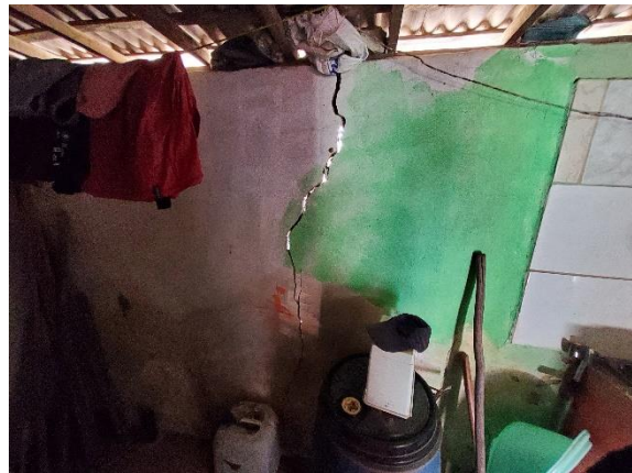
Figura 18 – Rachadura vertical no meio de parede.
