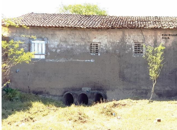
Figura 12 – Imóvel contruído na calha do riacho intermitente. Notar manilhas de passagem de águas.
