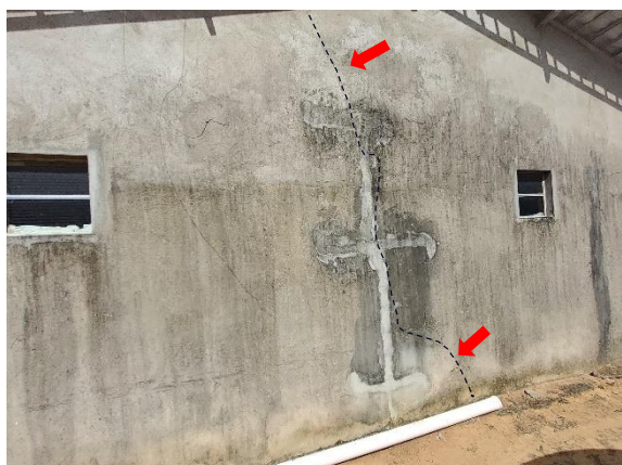
Figura 23 – Rachadura em parede fechada com o desenvolvimento posterior de fissura.
