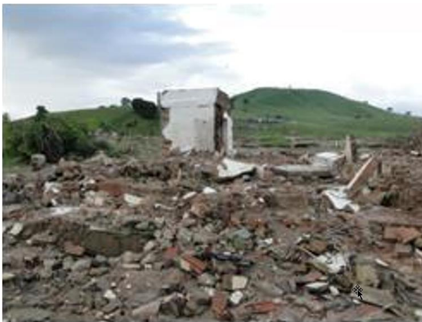
Figura 2.6 – Destruição total das casas na margem direita do rio Mundaú em União dos Palmares na cheia de 2010. Fonte: CPRM, 2010.
