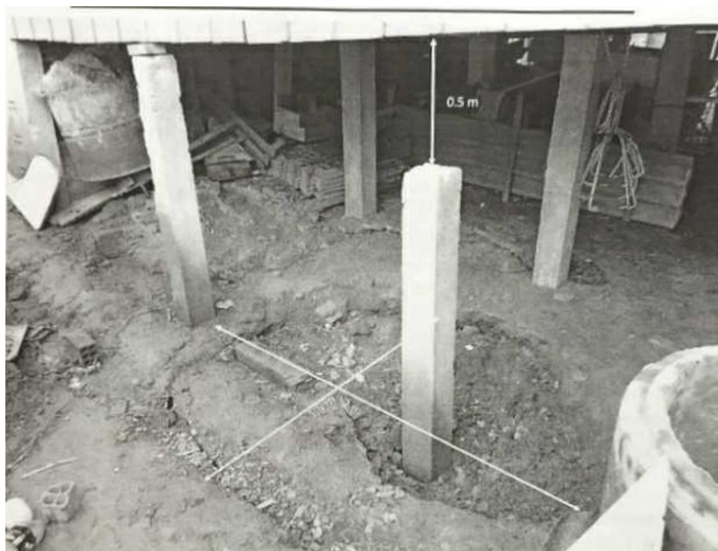
Figura 12: Fundação de moradia atingida por afundamento de solo. Rua Antônio Elias, 840 - Rio Branco do Sul – PR. Fonte: Relatório de inspeção ambiental. 2017.
