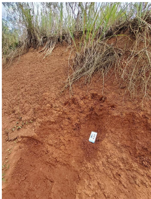
Figura 21: Ponto de campo número 06 – Solo residual de filito/metassiltito, coordenadas UTME: 672634; UTMN: 7214174. Rio Branco do Sul – PR.
