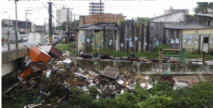
Figura 20 - Canal obstruído por entulho e lixo.
