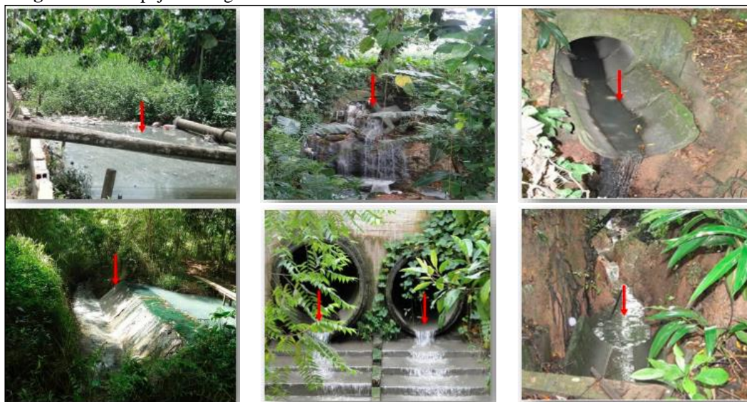
Figura 11 - Despejos de esgoto na área do PEUt.
