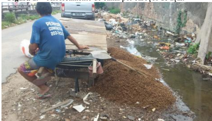
Figura 19 - Assoreamento de canal por caroços de açaí.
