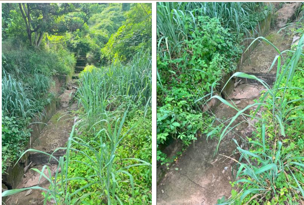
Foto 7 - Desgastes nas paredes do canal de drenagem superior.
