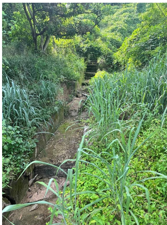
Foto 3 – Galeria pluvial subdimensionada.
