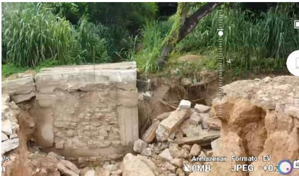
Foto 11 - Ponto crítico decorrente de processo erosivo acelerado.
