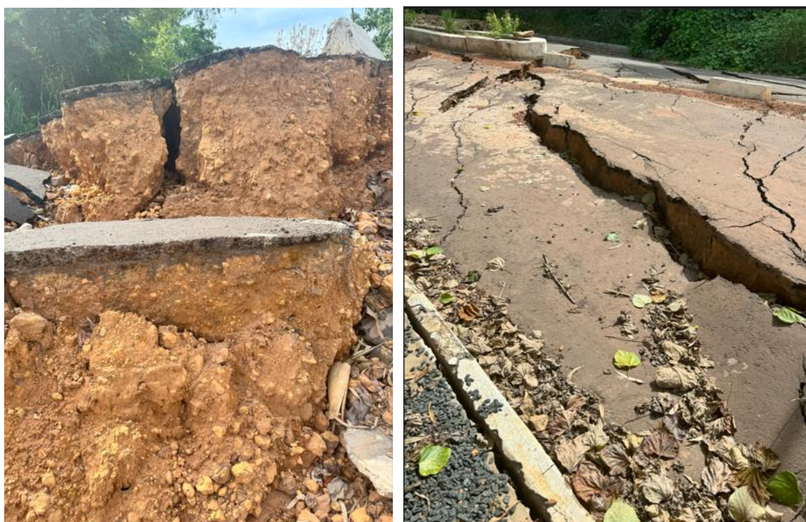
Foto 6 - Má compactação da base e fissuras no pavimento asfáltico.
