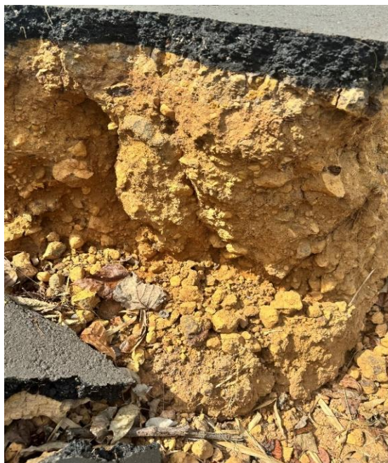
Foto 2 – Espessura solo em relação ao pavimento asfáltico.
