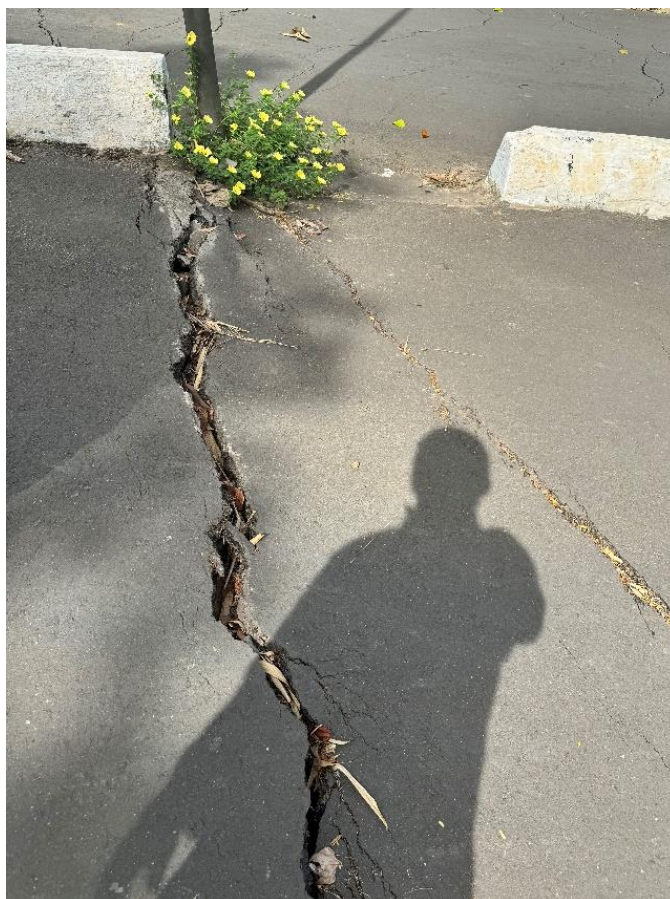
Foto 4 – Rachaduras com indicativa de movimentação do solo.
