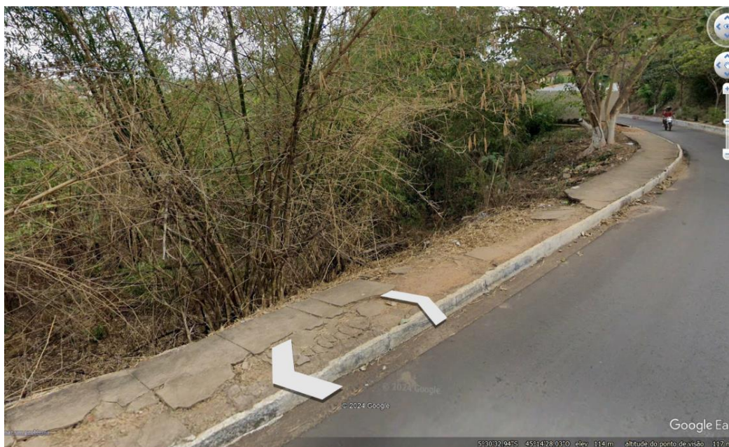
Imagem 3 - Manutenção precária do trecho afetado (Google Earth 2024).
