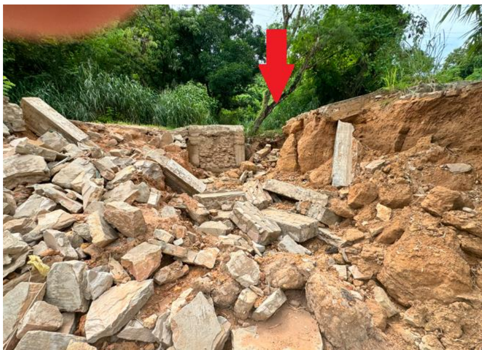
Foto 8 - Entrada de água por sobre a via sem passar pelos dispositivos de drenagem.
