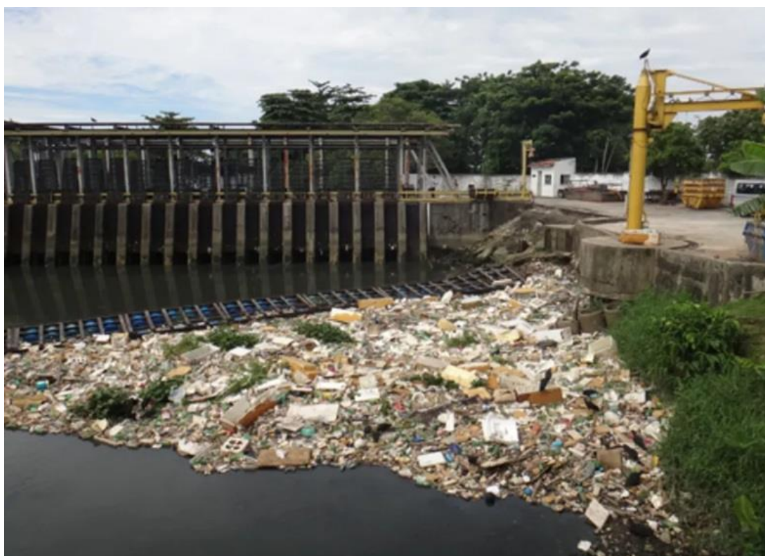
Figura 8 – Comportas da Macrodrenagem da bacia do Una.
